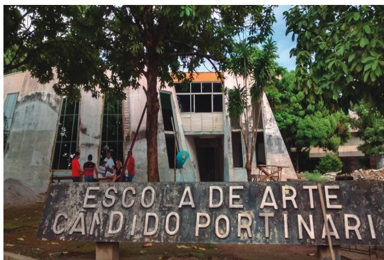
Figura 21 – Degradação do prédio da Escola de Artes Cândido Portinari.
