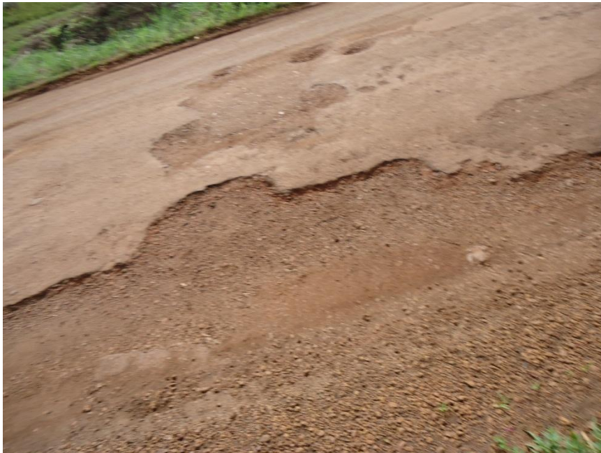
FIGURA 12: Precária camada asfáltica
