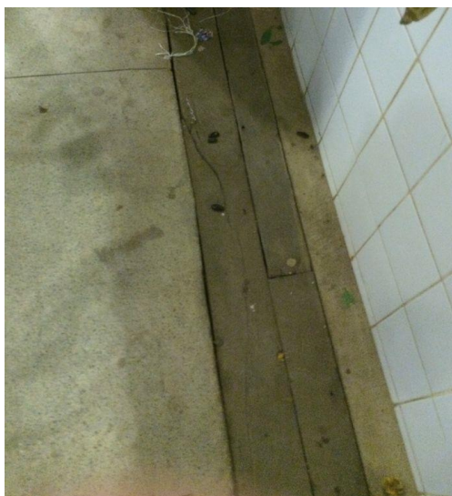
Fotografia 19 - Valas de drenagem fechadas com madeira.
