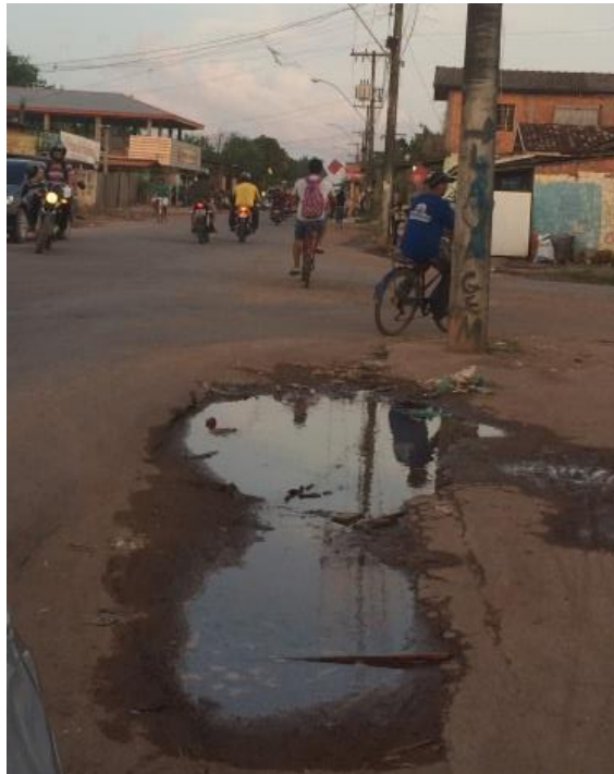
Figura 4 – Sistema de drenagem ineficiente
