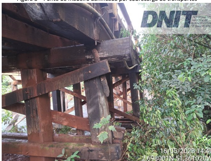
Figura 8 – Ponte de madeira danificada por sobrecarga de transportes
