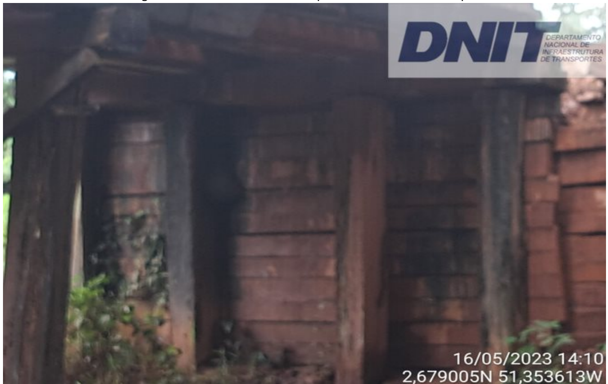
Figura 5 – Estacas de madeiras de pontes rodoviárias do amapá
