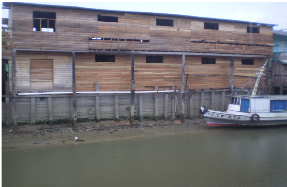
Foto 8: Estrutura sendo construída às margens do canal sobre área aterrada. Fonte: Damasceno (2009)
