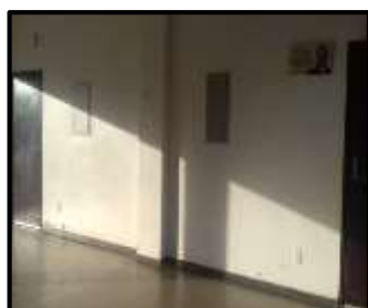
Pintura de cor branca se desgasta muito rápido.
