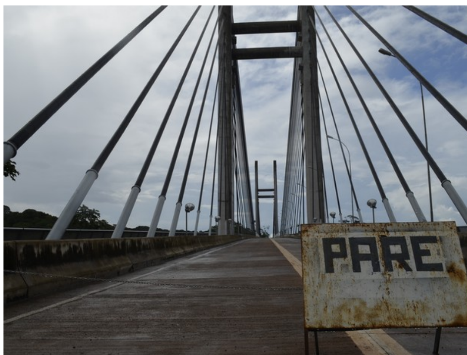
Figura 7 - Ponte concluída sem ter previsão para sua inauguração
