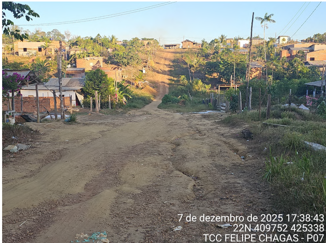
Figura 75: Ponto de alagamento P07.
