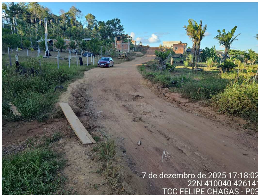
Figura 69: Ponto de alagamento P03.
