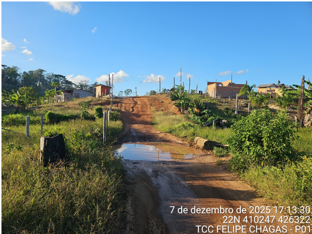
Figura 67: Ponto de alagamento P01.
