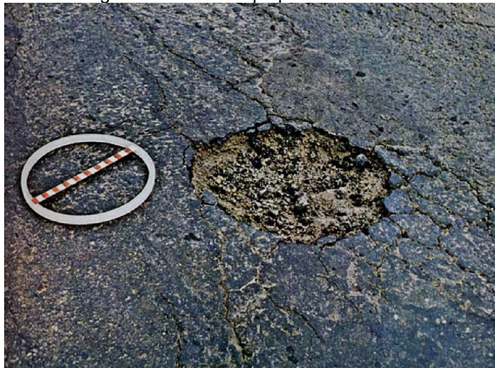
Figura 13 - Defeito tipo panela ou buraco
