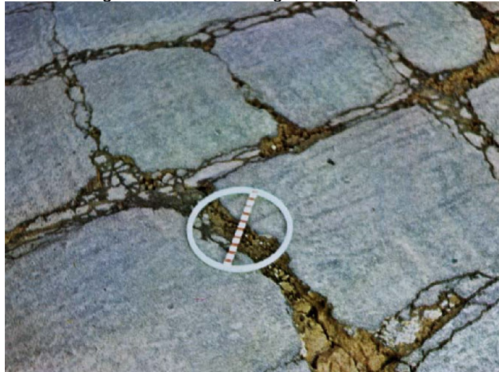
Figura 8 - Trinca interligada do tipo bloco
