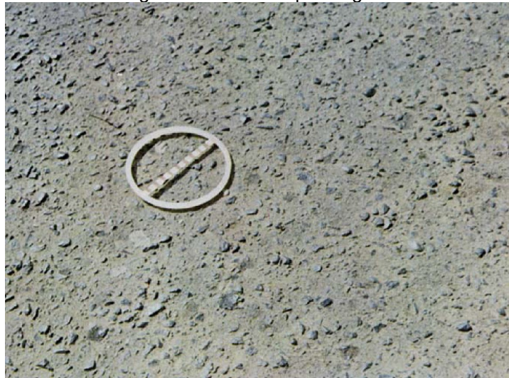
Figura 15 - Defeito tipo desgaste
