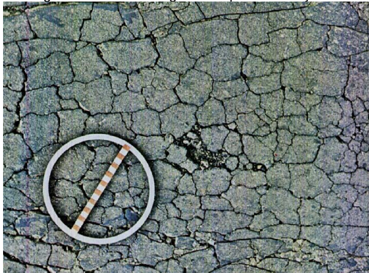
Figura 7 - Trinca interligada do tipo couro de jacaré
