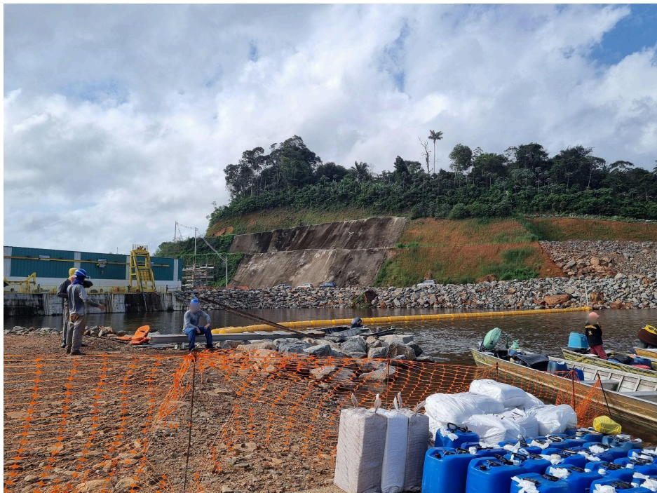
Figura 11 - Pequena Central Hidrelétrica Salto Cafesoca na travessia Grand Roche
