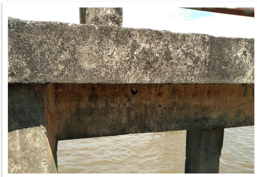
Figura 48 - Desgaste do concreto da viga
