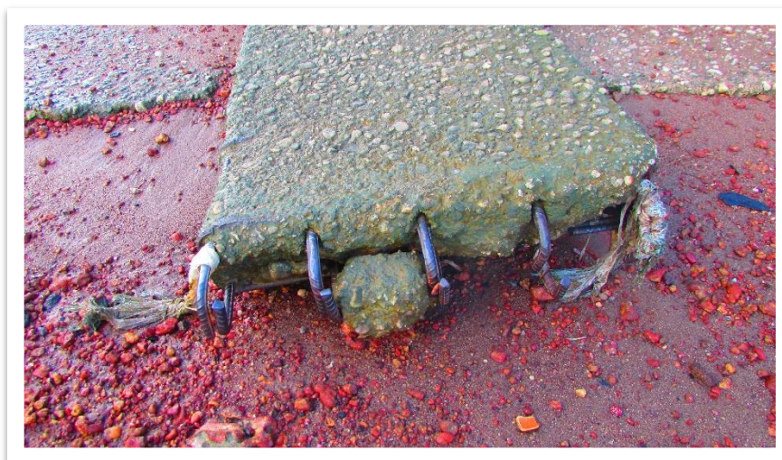
Figura 36 - Armadura exposta de placa pré-moldada
