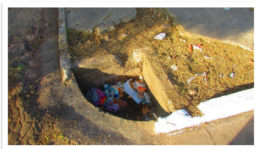
Figura 31 - Boca de lobo obstruída - Rua Beira Rio
