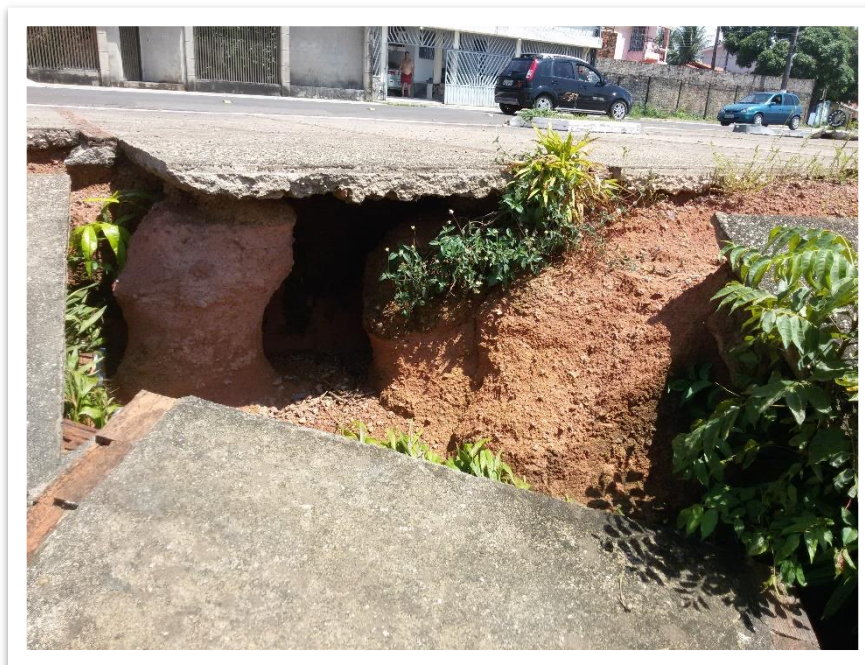
Figura 44 - Erosão sob a calçada
