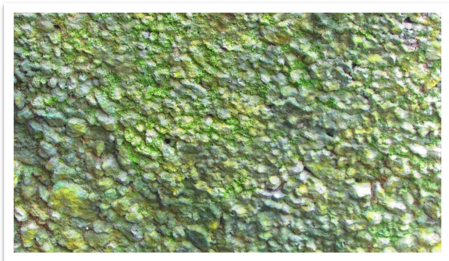
Figura 63 - Desgaste da superfície do concreto
