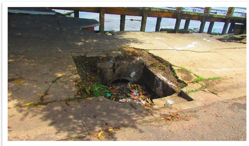
Figura 76 - Pontos críticos da contenção - 2
