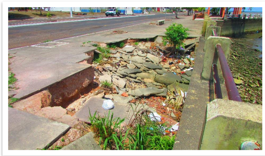
Figura 75 - Pontos críticos da contenção - 1
