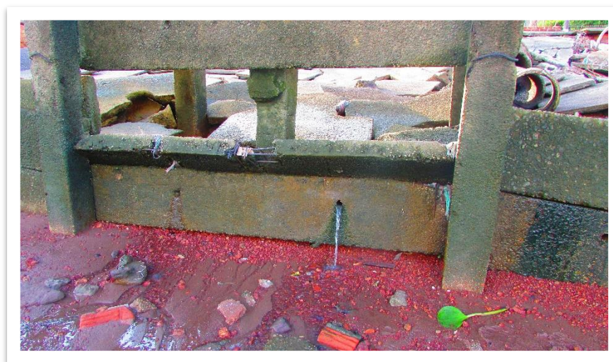
Figura 32 - Indícios de lançamento de águas residuais no Amazonas
