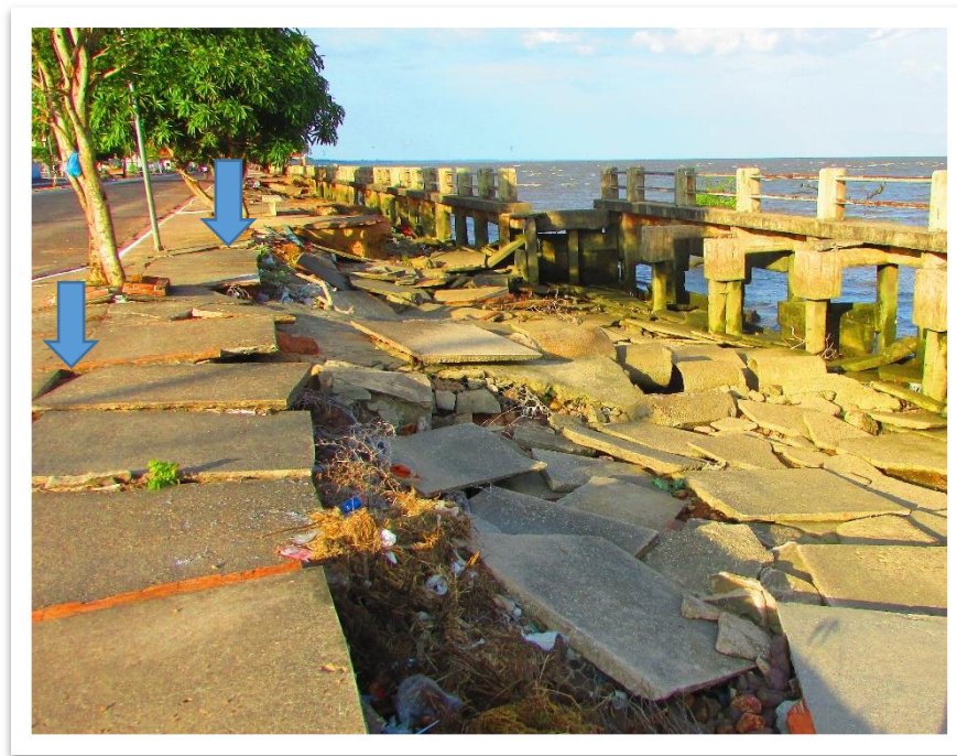
Figura 47 - Localização do desabamento em 09 de novembro de 2019.
