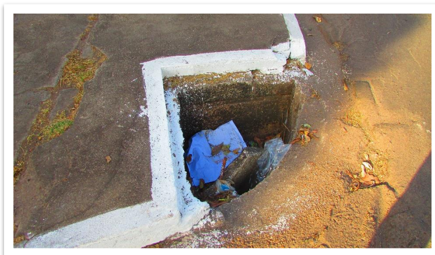
Figura 30 - Boca de lobo obstruído localizado na rua Beira Rio
