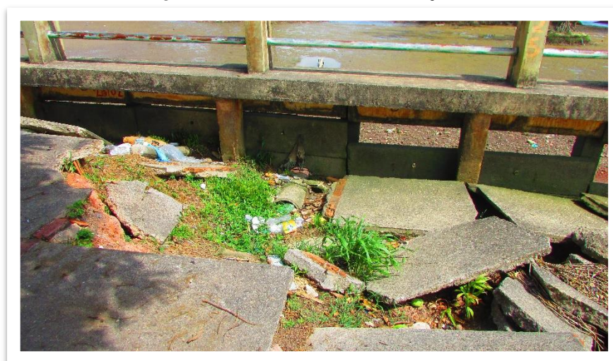
Figura 78 - Pontos críticos da contenção - 4
