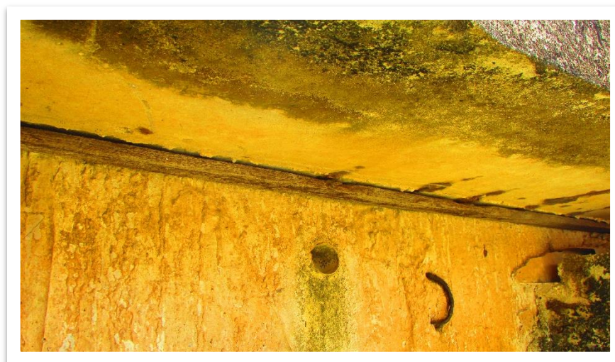
Figura 51 - Presença de madeira na fase inferior da viga
