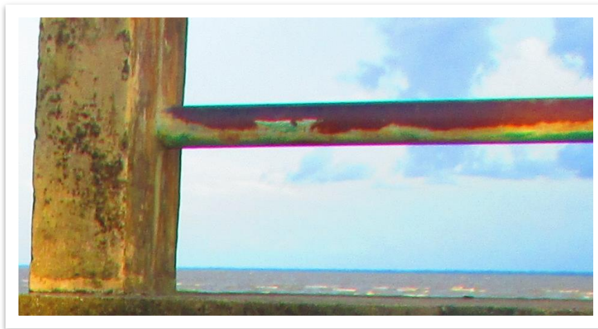
Figura 56 – Desgaste do guarda-corpo
