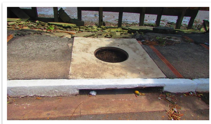
Figura 77 - Pontos críticos da contenção - 3
