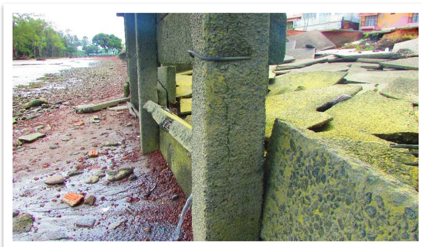
Figura 67 - Fissuras e trincas verticais e ferragem exposta
