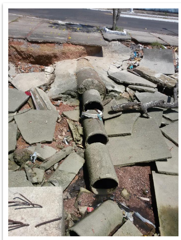
Figura 41 - Tubulação de água pluvial danificada
