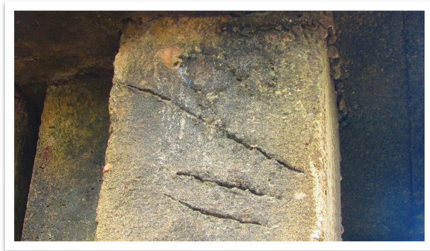
Figura 64 – Anomalia observada no pilar 1
