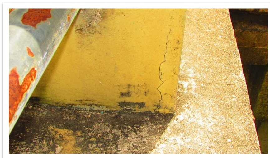
Figura 57 - Fissuras no elemento do guarda-corpo
