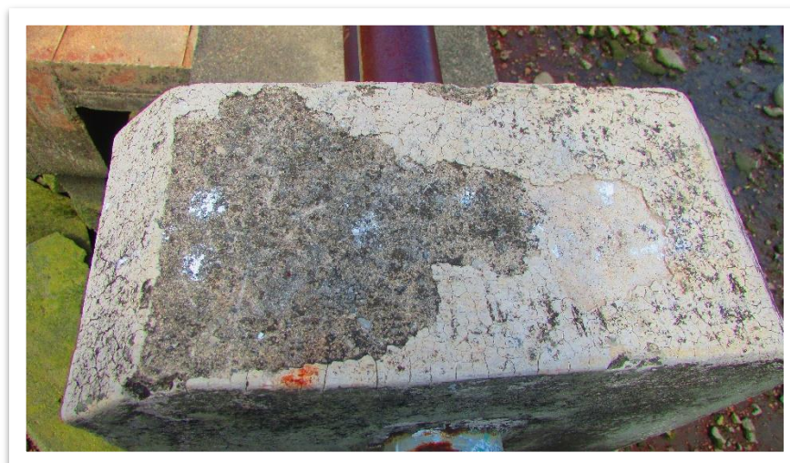
Figura 58 - Deterioração da superfície do concreto
