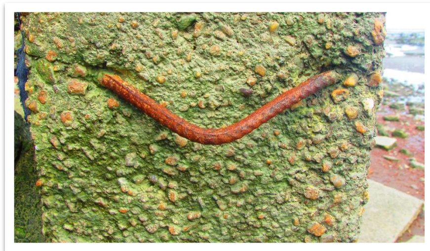
Figura 65 - Corrosão da armadura
