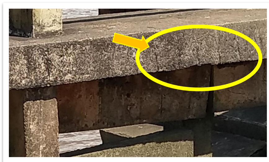
Figura 49 - Fissuras na viga
