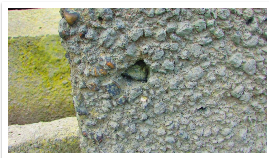
Figura 66 - Desgaste do concreto por erosão
