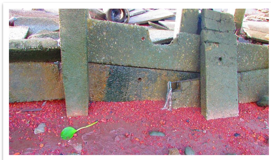
Figura 54 - Patologias nas placas pré-moldadas
