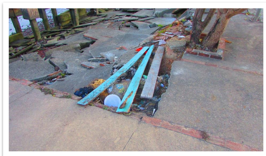
Figura 43 - Presença de lixo no trecho da contenção
