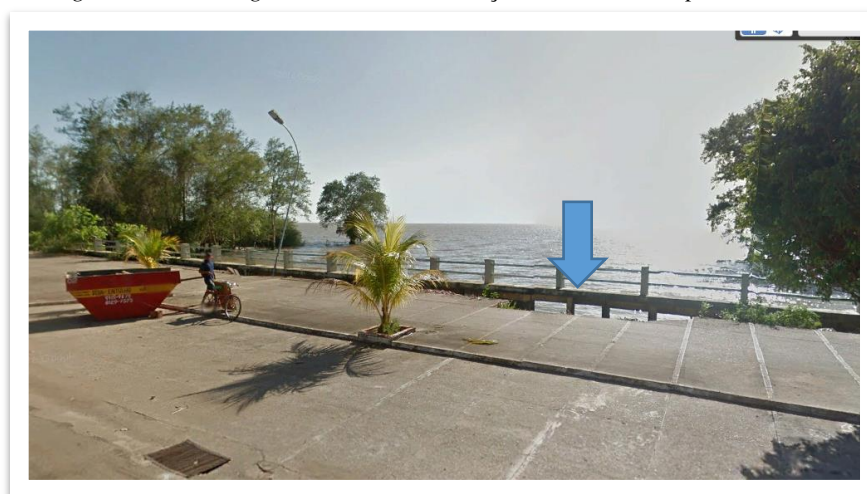
Figura 24 - Patologia no muro de contenção em 2012 - Perpétuo Socorro
