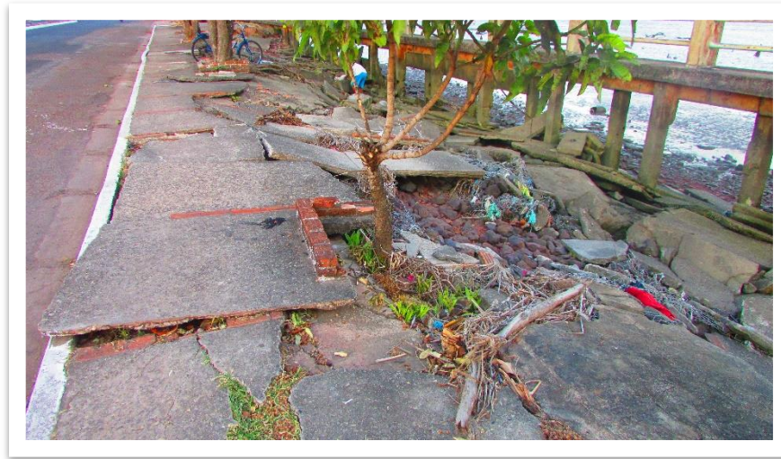
Figura 45 - Patologias na calçada
