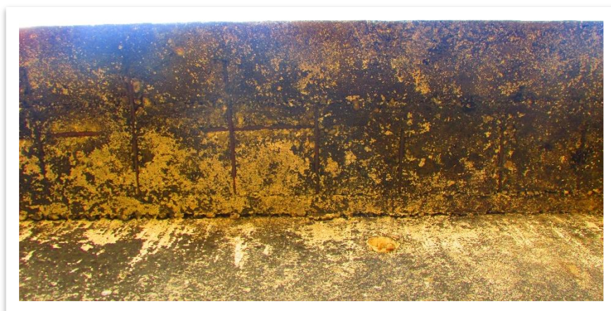
Figura 50 – Cobrimento insuficiente e corrosão da armadura da viga
