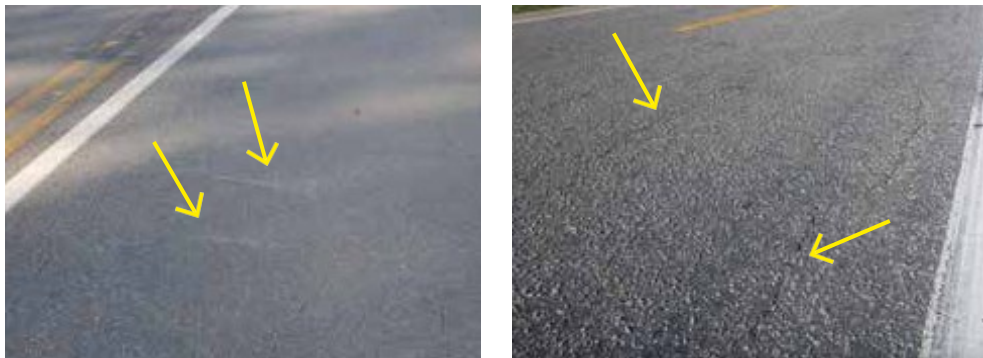
Figura 9: Fissuras no pavimento
