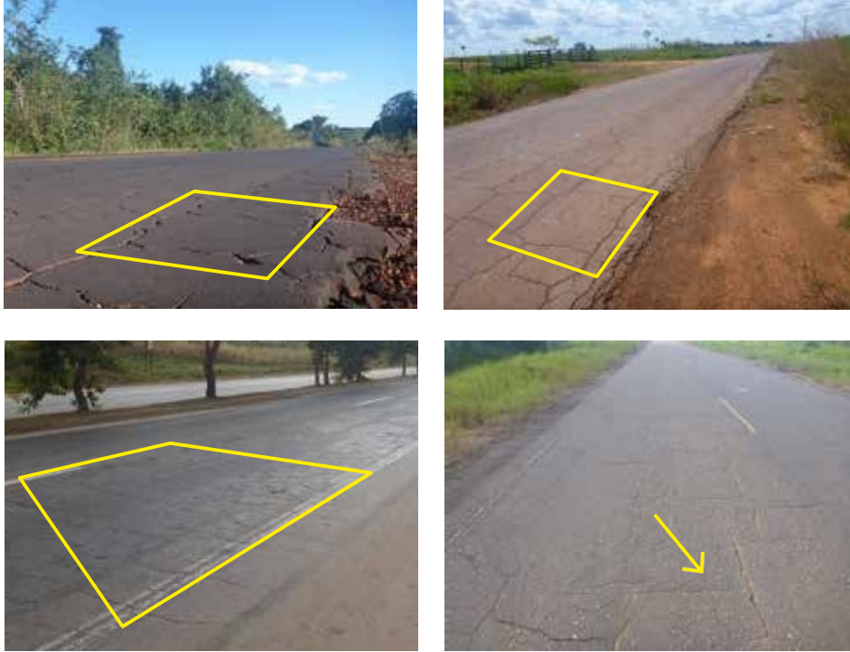
Figura 14: Trinca em malha tipo “Bloco”
