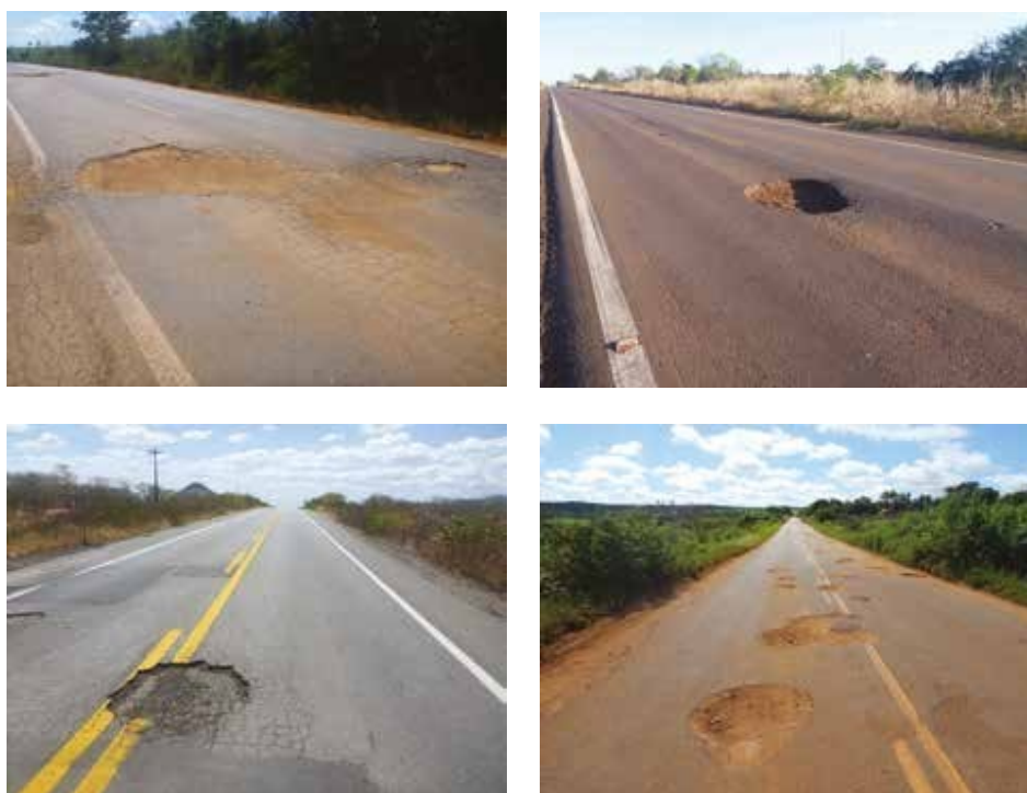
Figura 23: Panela ou buraco
