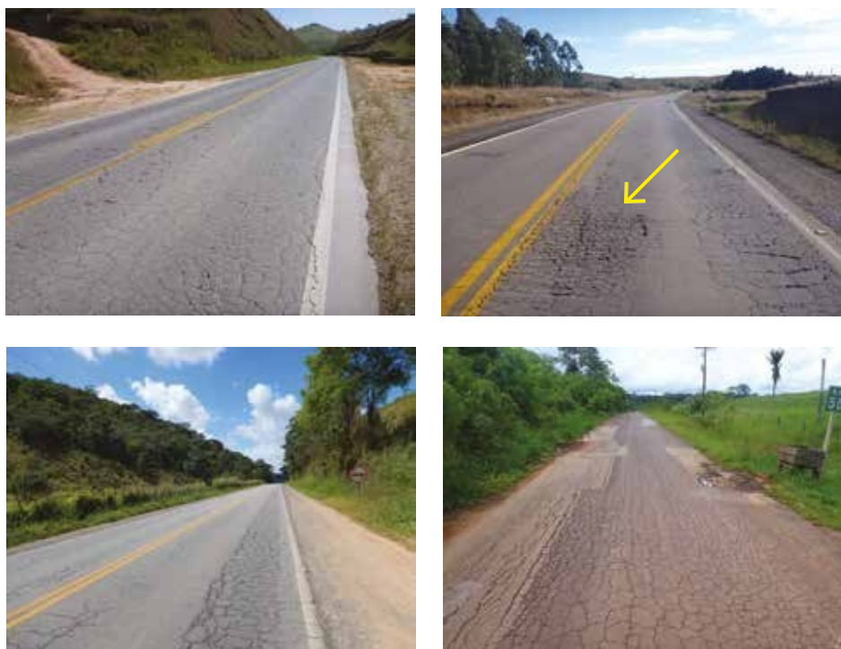
Figura 13: Trinca em malha tipo “Couro de Jacaré”
