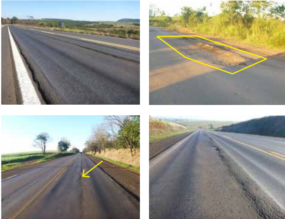
Figura 15: Afundamento plástico nas trilhas de roda
