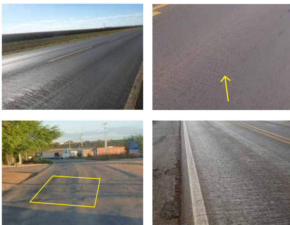
Figura 19: Ondulação ou corrugação
