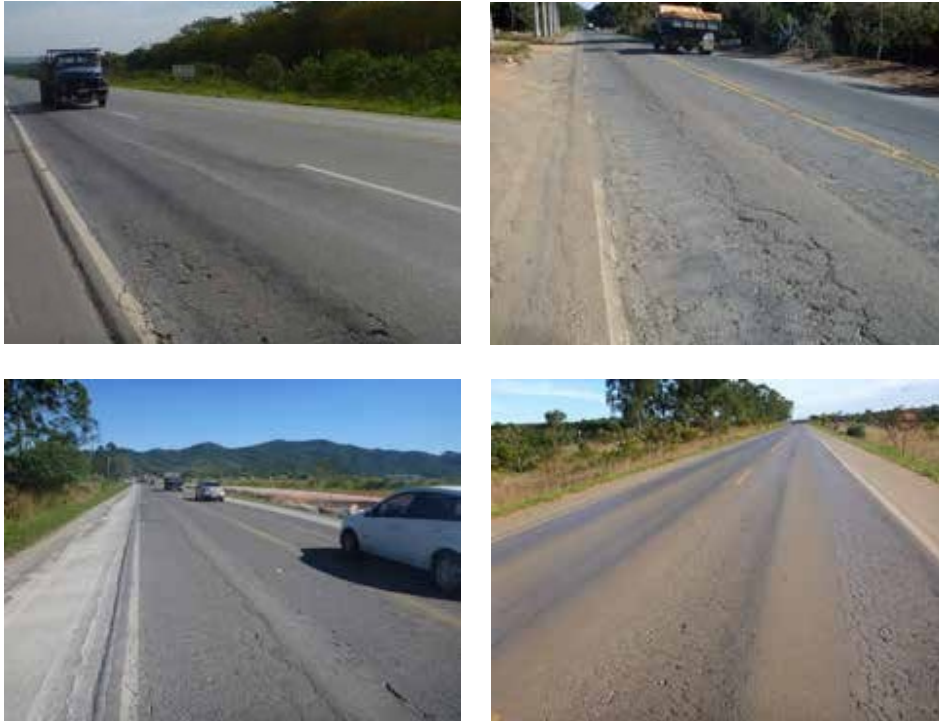
Figura 17: Afundamento por consolidação nas trilhas de roda
