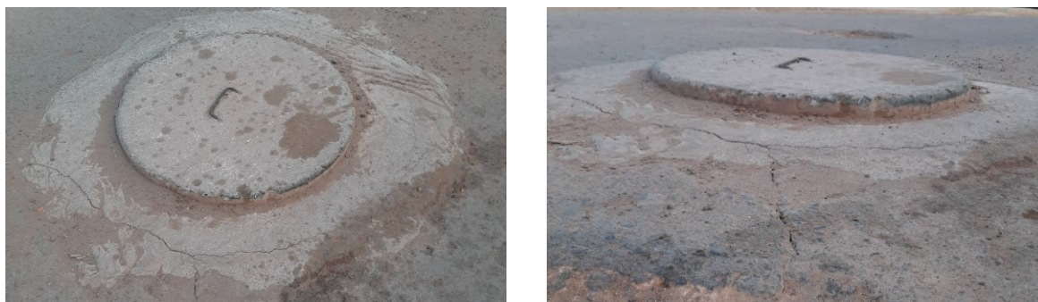
Figura 37: Desnívelamento da tampa do PV e a aparição de trincas ao redor
