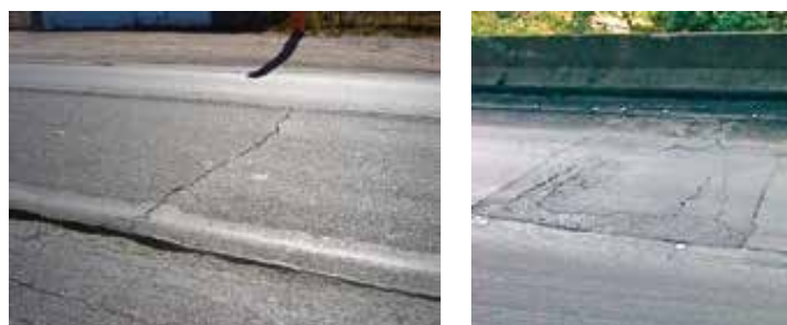
Figura 12: Trinca de retração
