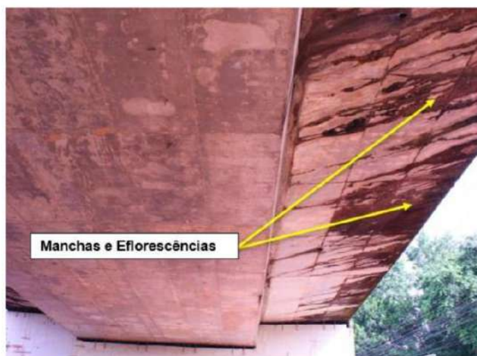
Figura nº 06: Mostra as manchas e eflorescência na estrutura da ponte na região inferior do tabuleiro.
