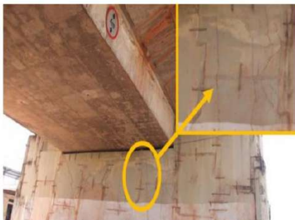
Figura nº 11: Trincas provenientes de redistribuição de esforços.
