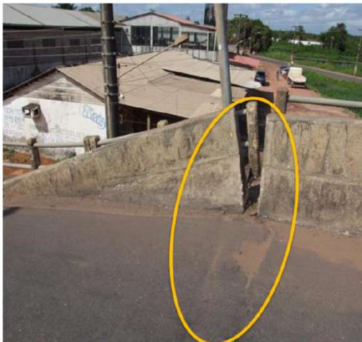
Figura nº 16: Fenda no pavimento asfáltico
