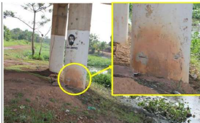
Figura nº 07: Mostra o destacamento do cobrimento da armadura.
