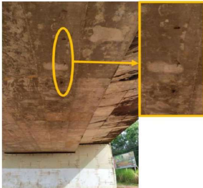
Figura nº 05: Mostra pontos de corrosão na estrutura da ponte na região inferior do tabuleiro.
