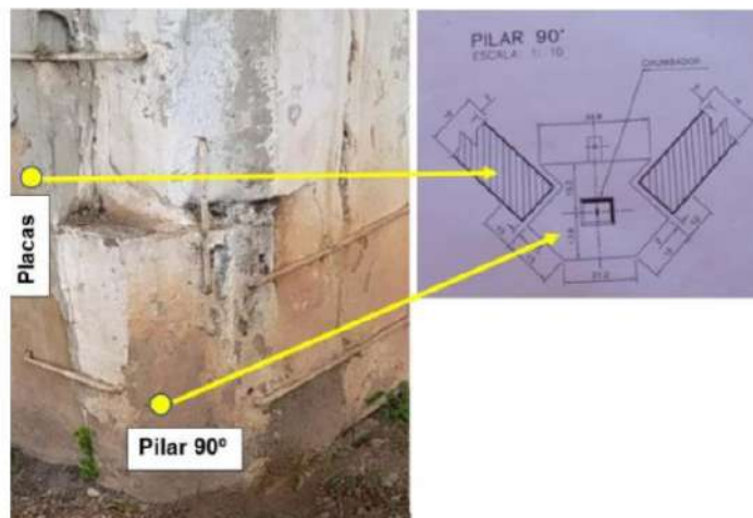
Figura nº 09: Anomalias nos pilares e a representação no projeto.
