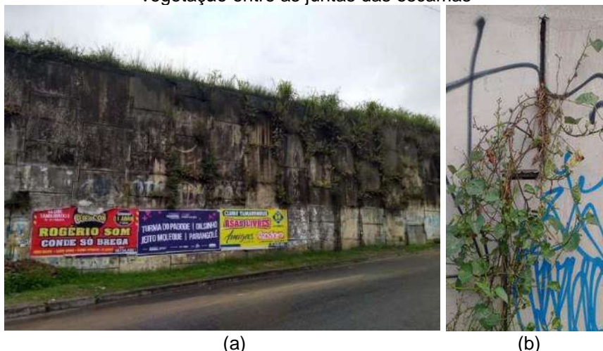
Figura 14 – Muros em terra armada: (a) Grande quantidade de bolor e vegetação (b) Presença de vegetação entre as juntas das escamas
