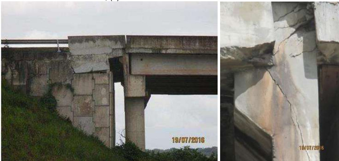
Figura 12 – (a) Rotação da laje de transição causada pela deformação do aterro sobre camada de solo mole; (b) Danos causados na cortina e no console
