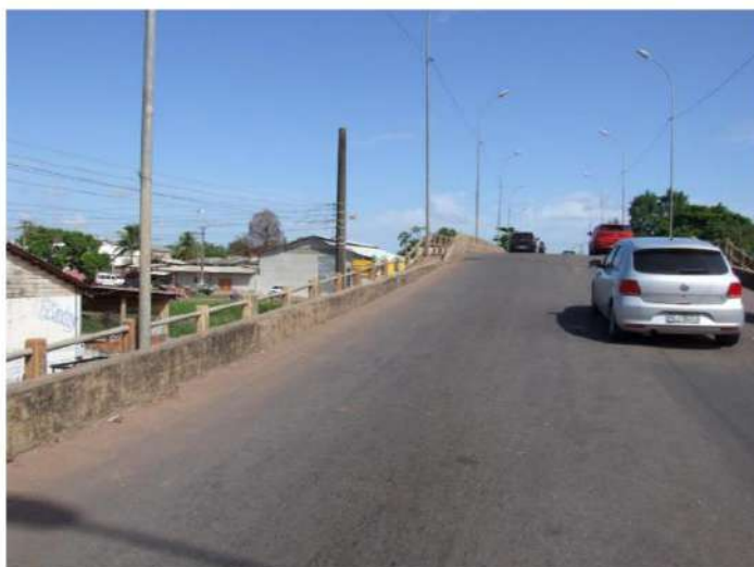
Figura nº 04: Mostra as condições física do pavimento asfáltico e de fluxo de veículos.
