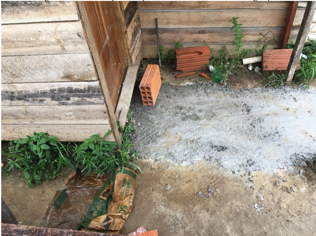
Figura 26: Resíduos espalhados pelo canteiro e em contato com vegetação.
