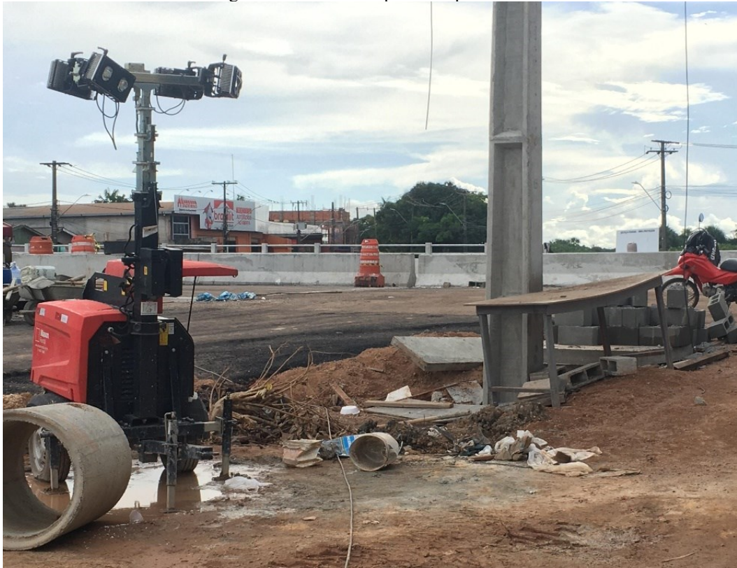
Figura 28: Resíduos espalhados pela obra.
