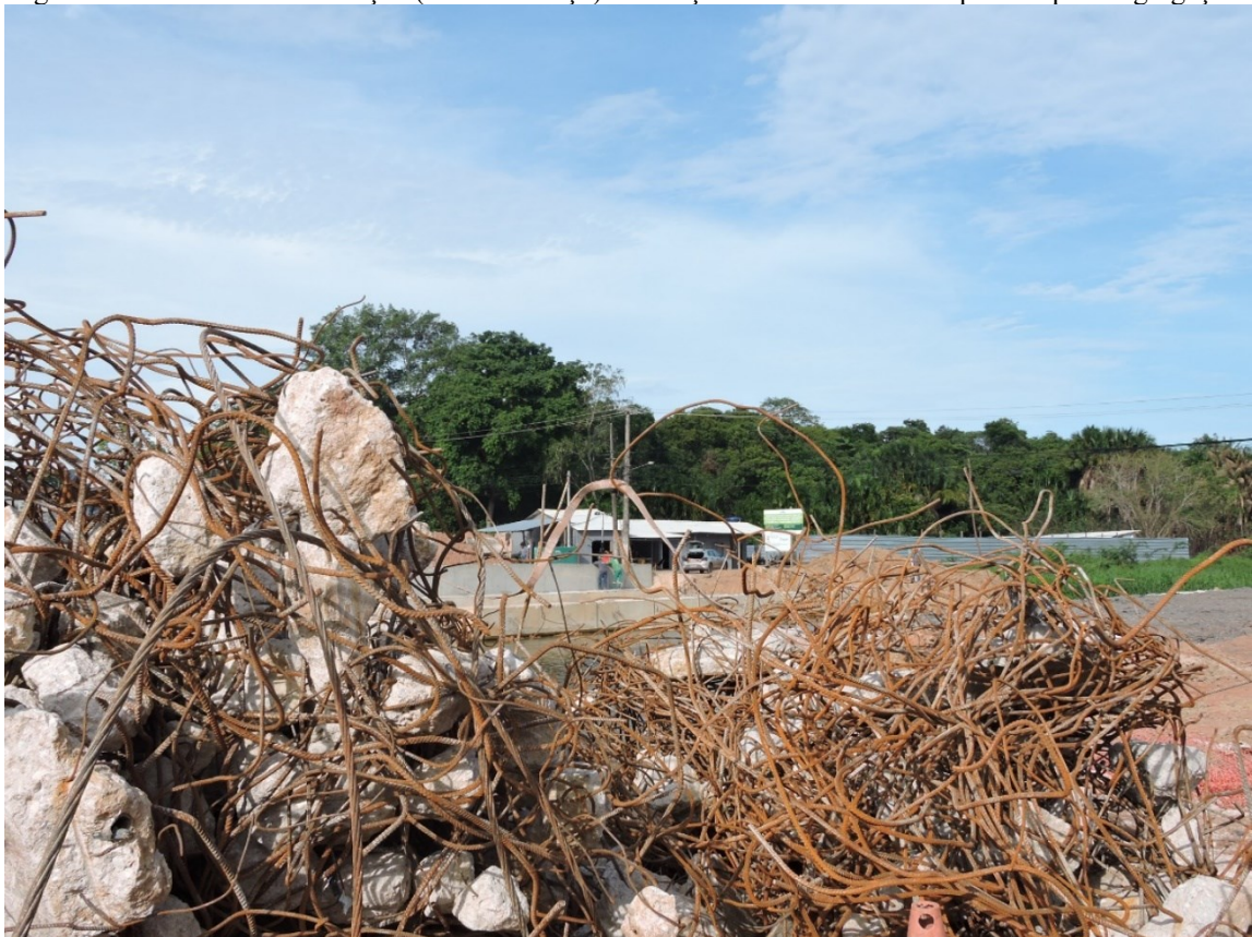
Figura 24: Resíduos da demolição (concreto e aço) entrelaçados citados como empecilho para segregação.
