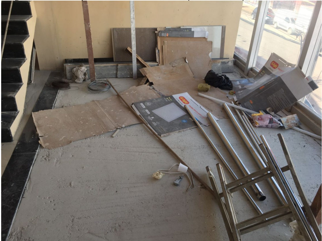
Figura 35: Resíduos dispostos sem acondicionamento adequado em um dos pavimentos do edifício.
