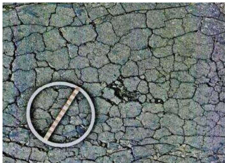
Figura 4 - Trinca em malha (couro de jacaré)
