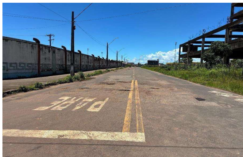
Figura 22 - Trecho com manifestações de defeitos no pavimento
