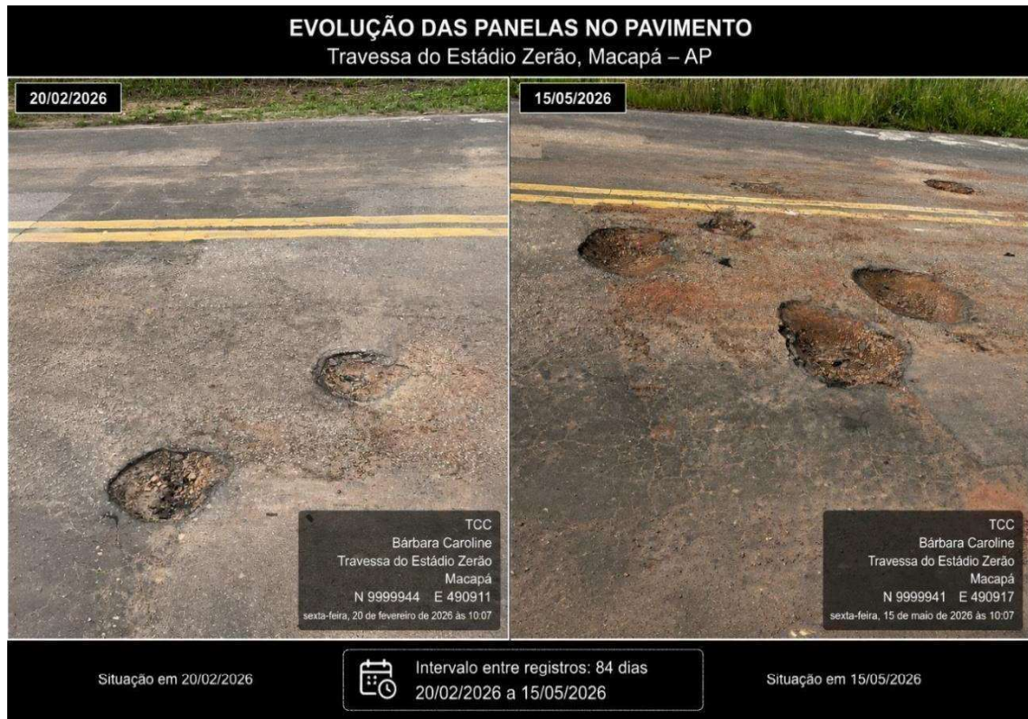
Figura 28 - Evolução das panelas no pavimento entre fevereiro e maio de 2026
