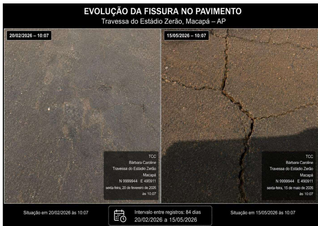
Figura 33 - Evolução de fissuras no pavimento monitorado
