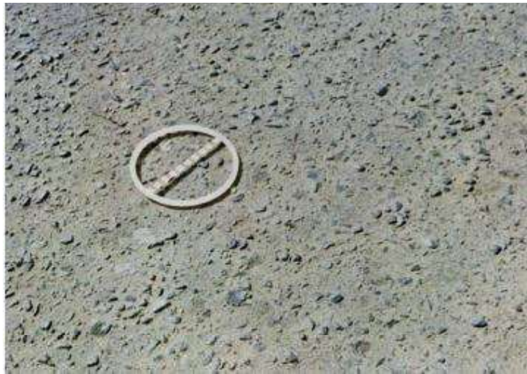
Figura 6 - Desagregação superficial do revestimento asfáltico
