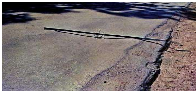
Figura 5 - Afundamento em trilha de roda
