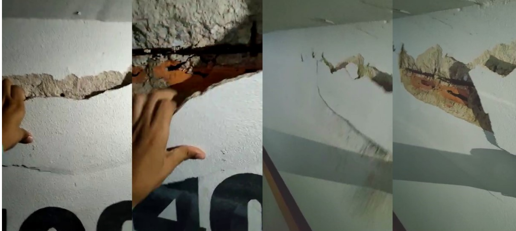
Figura 24 - Parede oca e com armadura oxidada.
