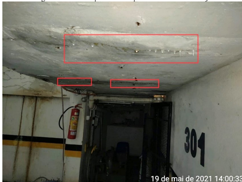
Figura 12 - Presença de formação de estalactite na laje
