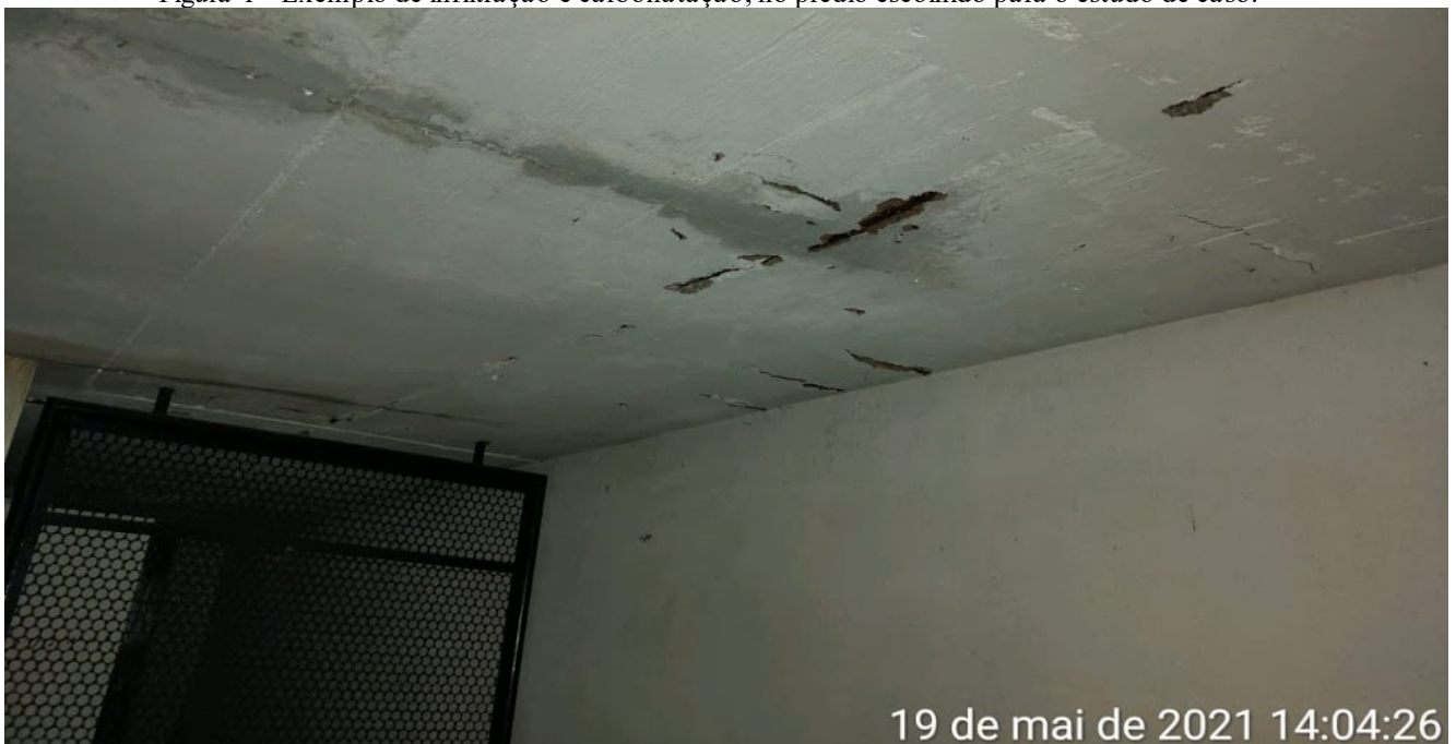
Figura 1 - Exemplo de infiltração e carbonatação, no prédio escolhido para o estudo de caso.
