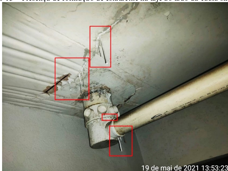
Figura 13 - Presença de formação de estalactite na laje ao lado da caixa sifonada
