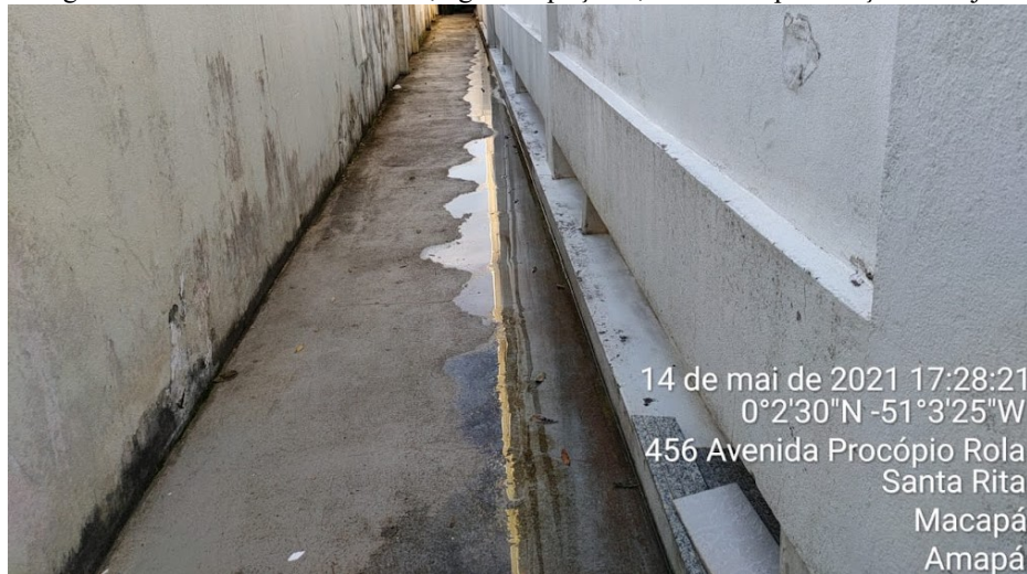
Figura 46 - Falta de escoamento, água empoçada, causando percolação na laje.
