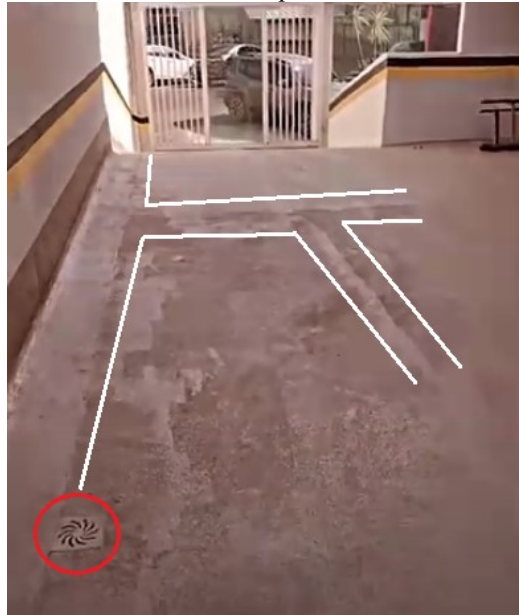
Figura 22 - O acréscimo de ralos (destaque me vermelho) e juntas de dilatação (destaque em branco) no novo contrapiso.
