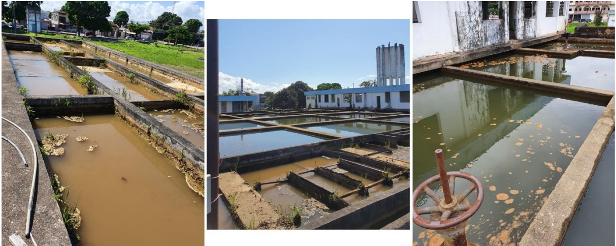
Figura 17: Floculadores, Decantadores e Filtros ETA 1.
