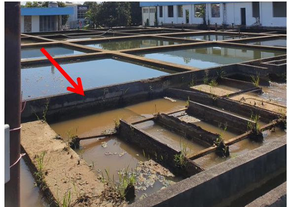
Figura 22: Ponto de coleta água floculada ETA 1.
