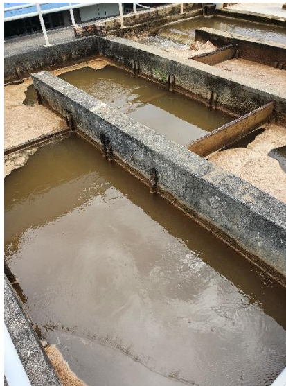
Figura 2: Floculador Hidráulico de Fluxo Horizontal CAESA
