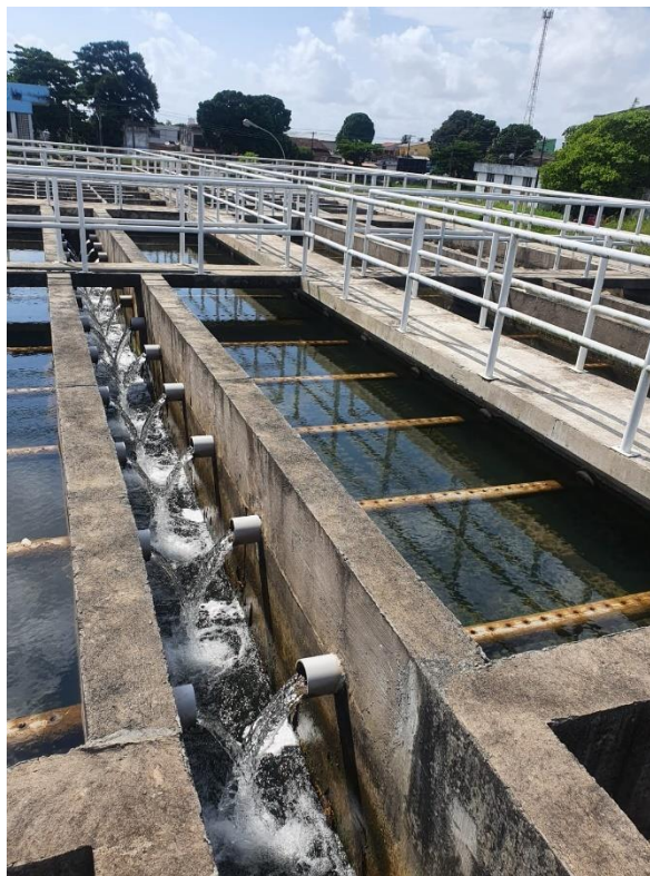
Figura 3: Decantadores ETA 3 Caesa
