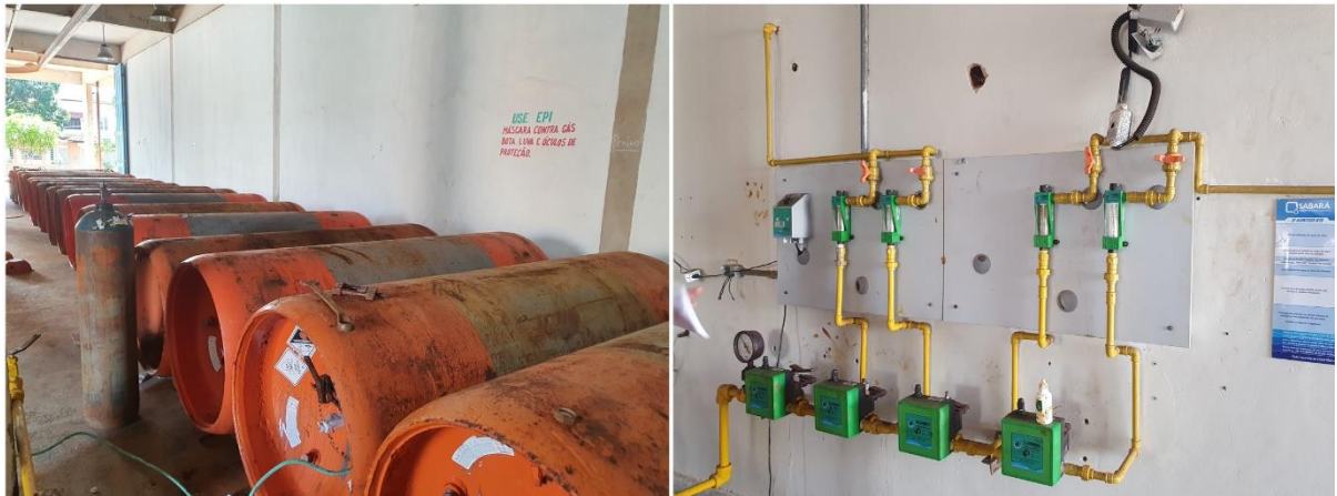
Figura 18: Sistema de Cloro Gás (ETA 1, 2 e 3) da ETAM
