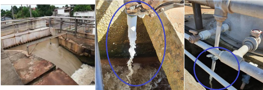
Figura 11: Calha Parshal e dosagem do coagulante.
