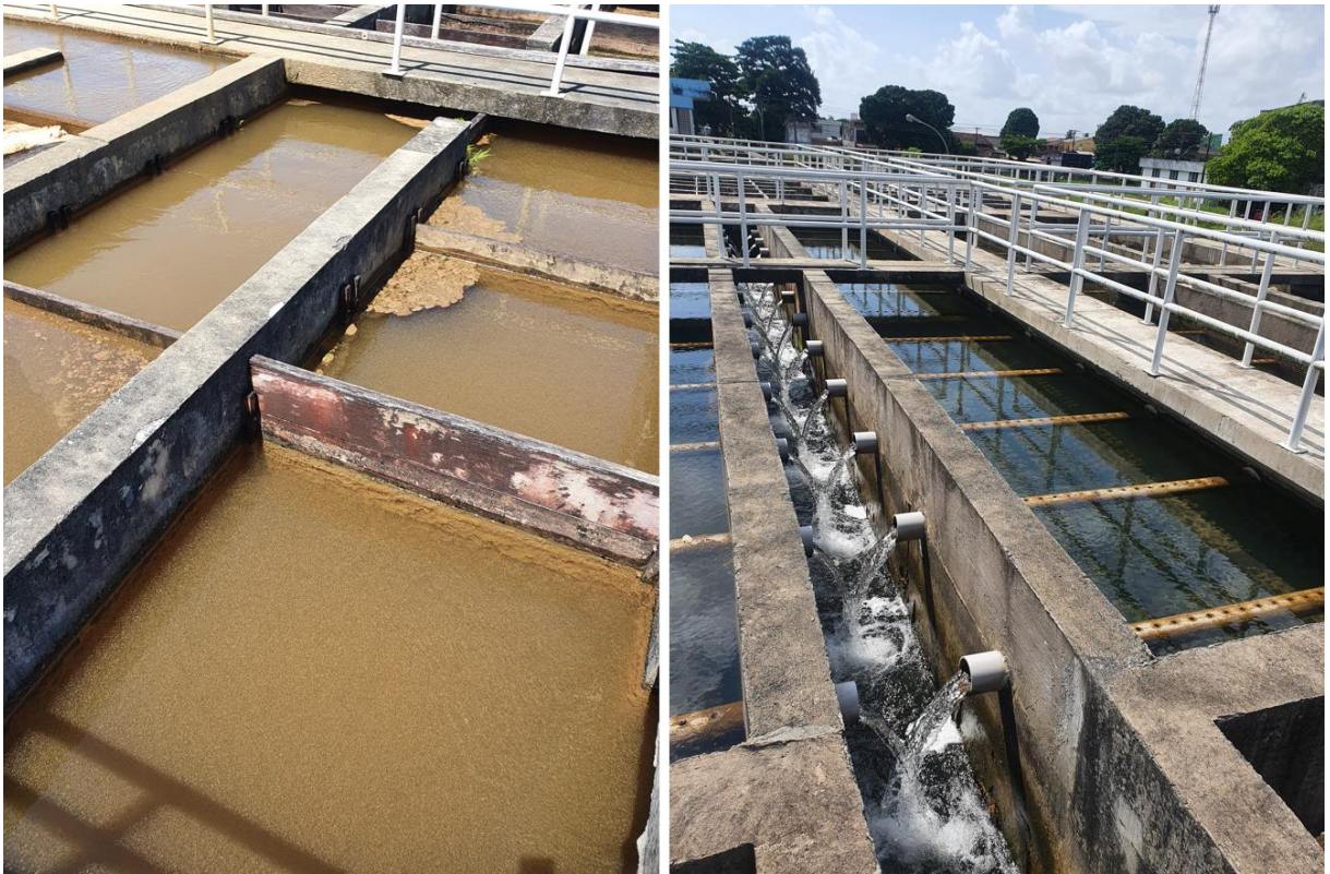
Figura 19: Floculadores ETA 2 e 3 (esquerda), Decantadores ETA 2 e 3 (direita)
