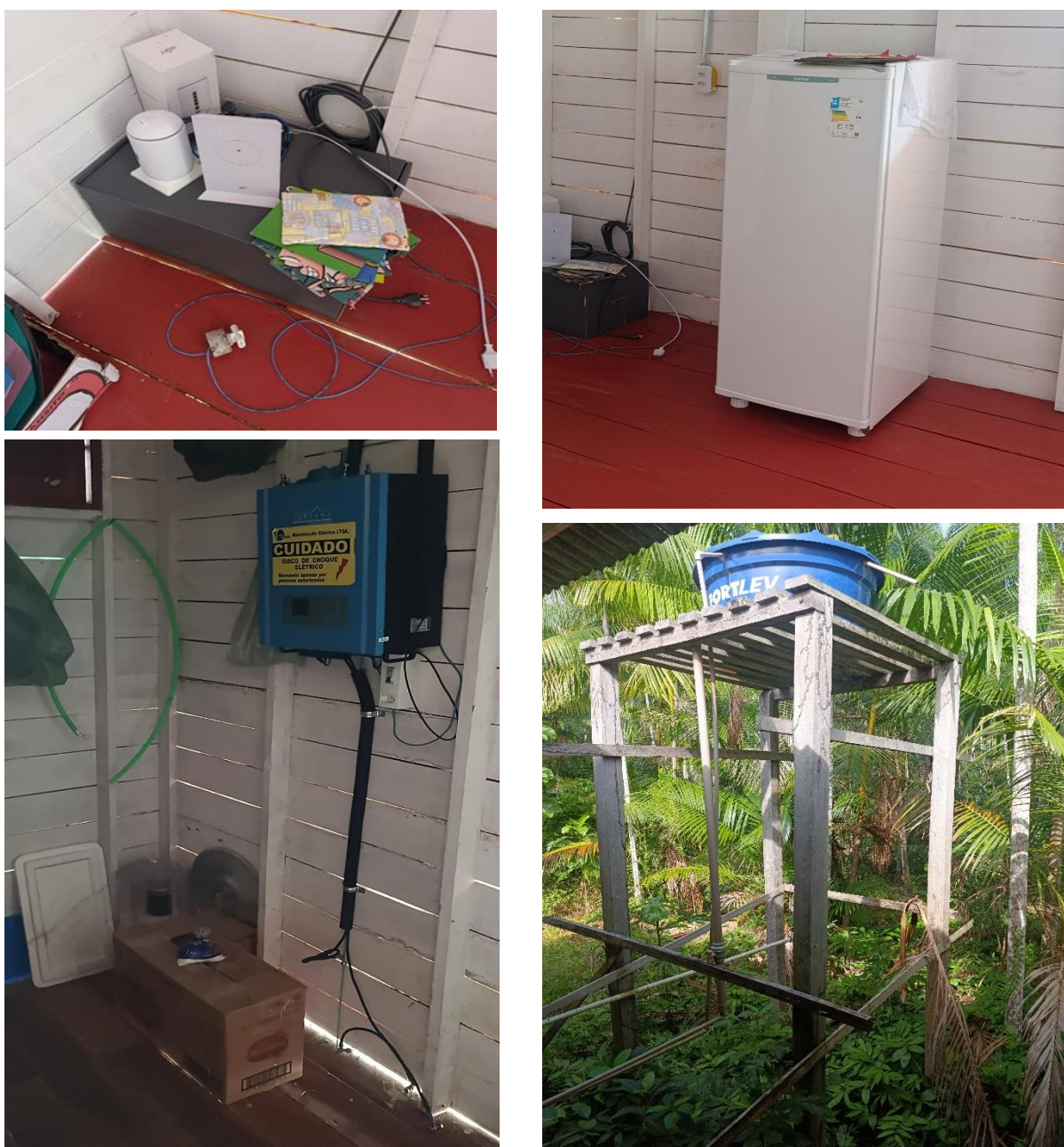
Figura 7 – Equipamentos sem funcionamento devido à ausência de energia elétrica
