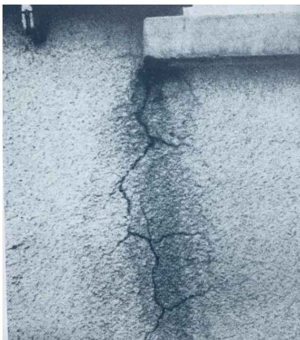
Figura 18 - Fissura causada pela água que escorre lateralmente ao peitoril
