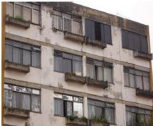
Figura 24 - Bolor em fachada
