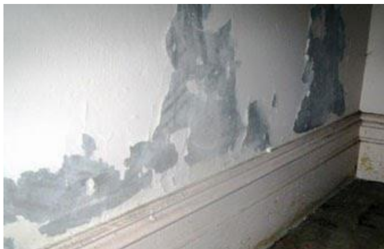
Figura 29 - Descascamento de pintura
