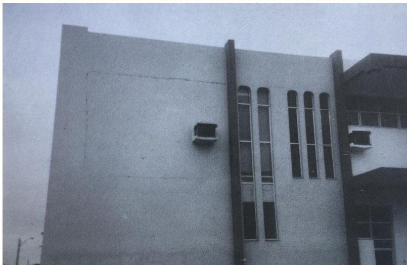
Figura 17 - Destacamento da alvenaria da estrutura devido a movimentação térmica diferenciada
