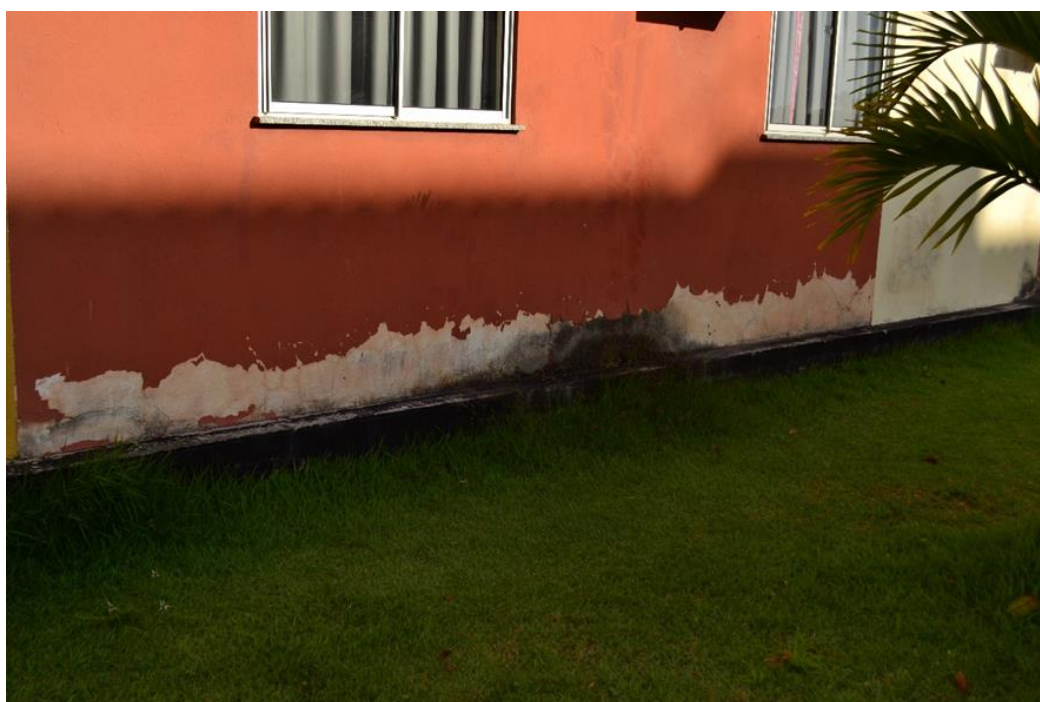
Figura 72 - Representação de descascamento de pintura do edifício
