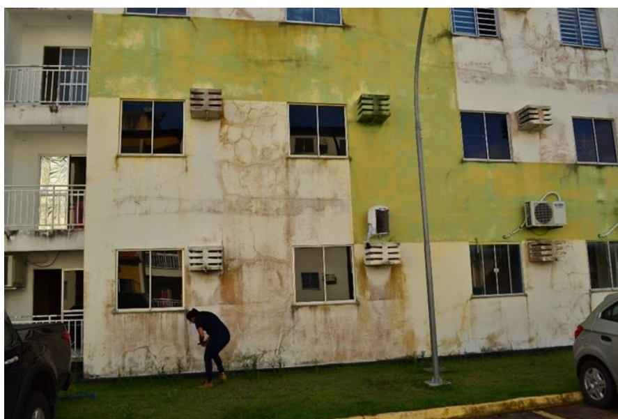
Figura 69- Representação de figuras mapeadas no Edifício E
