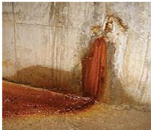
Figura 25 - Infiltração em subsolo
