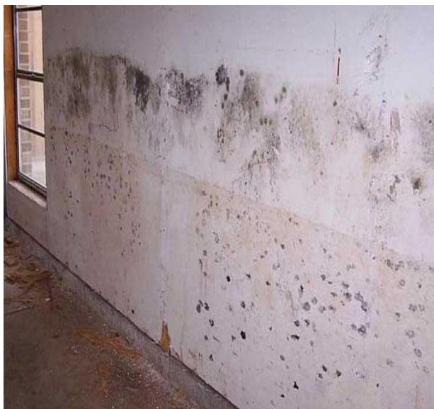
Figura 26 - Manchas devido à umidade
