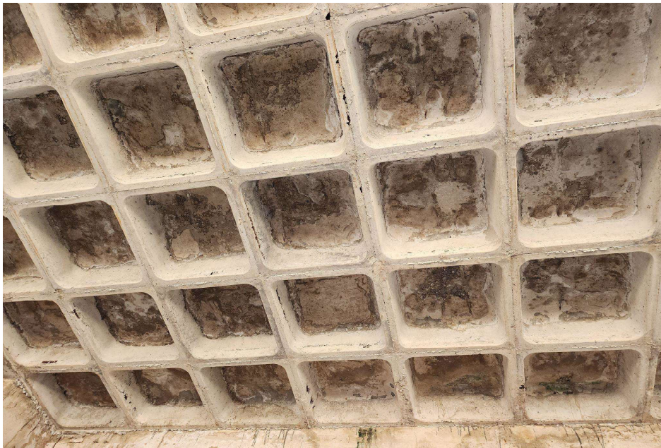
Figura 71: Laje L9 com manchas que indicam umidade
