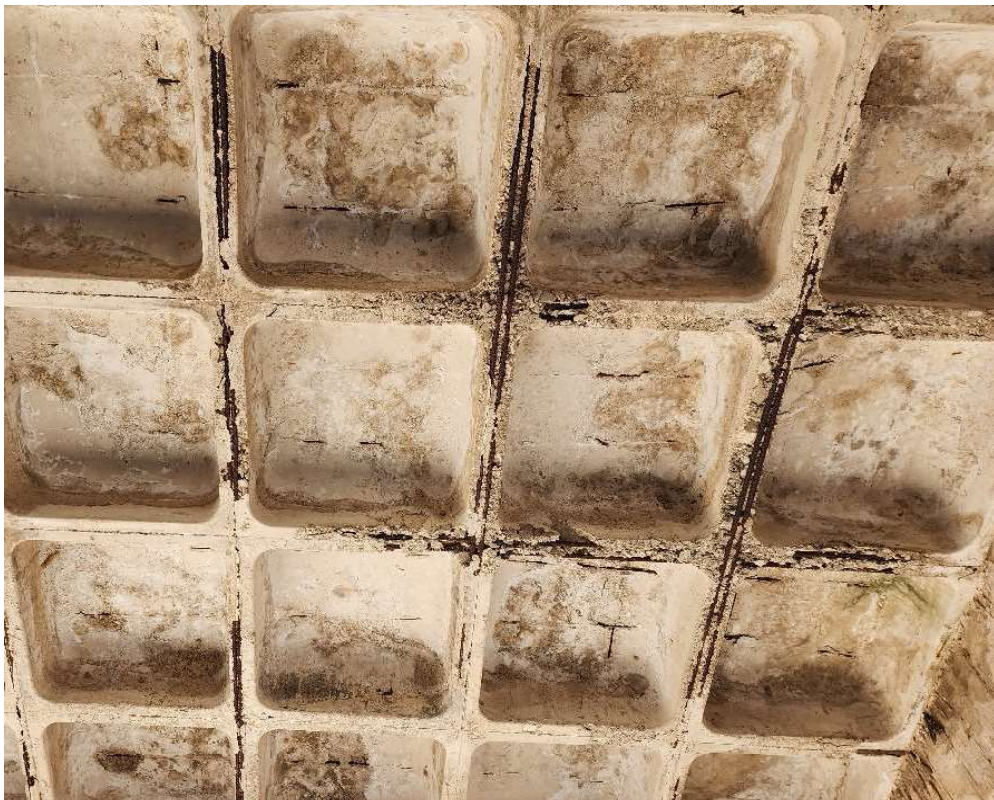
Figura 52: Laje L7 com deslocamento do concreto
