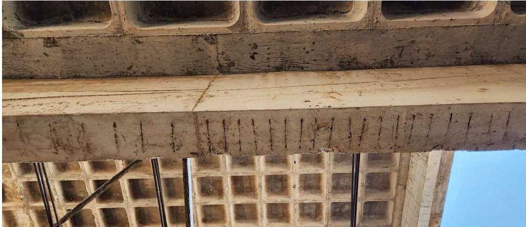
Figura 36: Viga V39 com espaçamento dos estribos não uniforme
