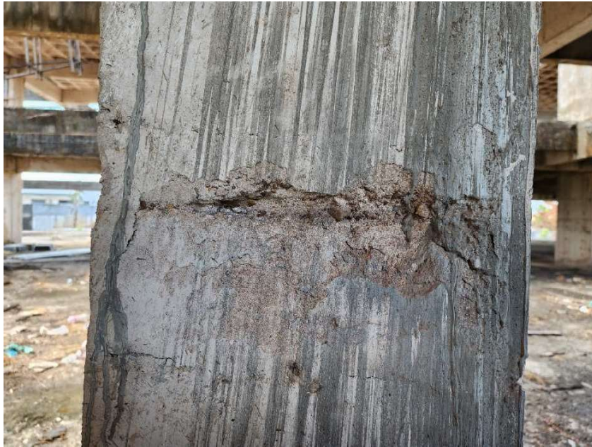
Figura 67: Segregação do concreto no meio do pilar P16
