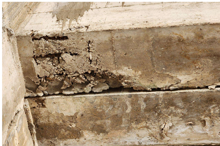
Figura 66: Segregação do concreto parte inferior da viga V46
