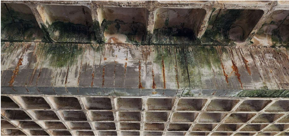
Figura 34: Viga V13 com corrosão severa dos estribos
