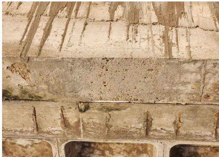
Figura 37: Viga V52 com superfície porosa e que apresenta corrosão dos estribos
