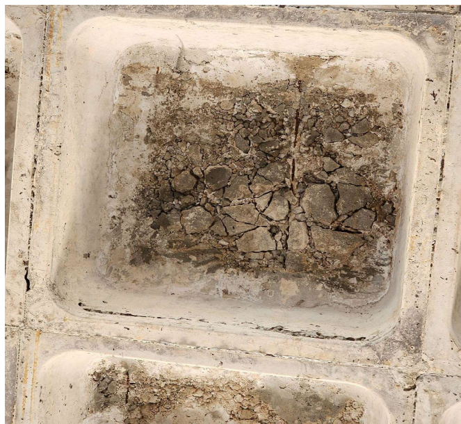
Figura 45: Processo de desagregação da laje L9 causado pela segregação do concreto
