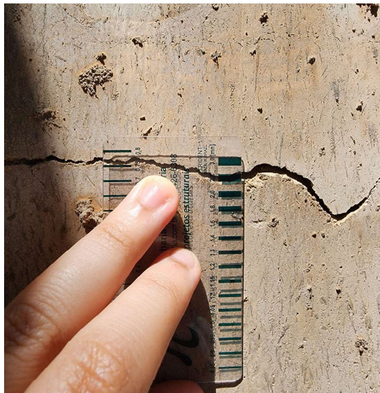
Figura 38: Fissura da ordem de 2,5mm no pilar P22
