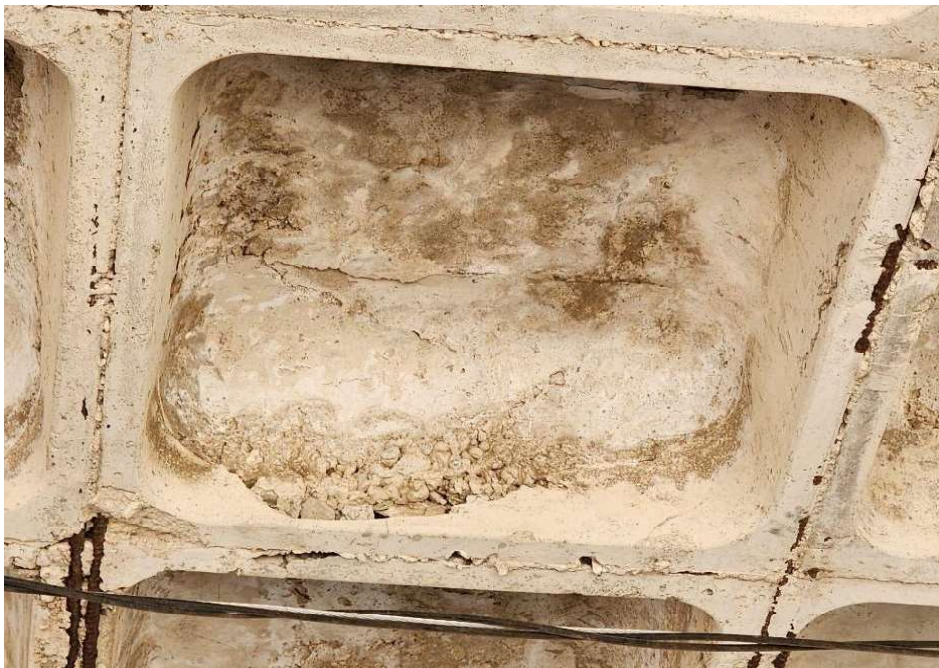
Figura 64: Acúmulo de agregados graúdos na nervura da laje L7
