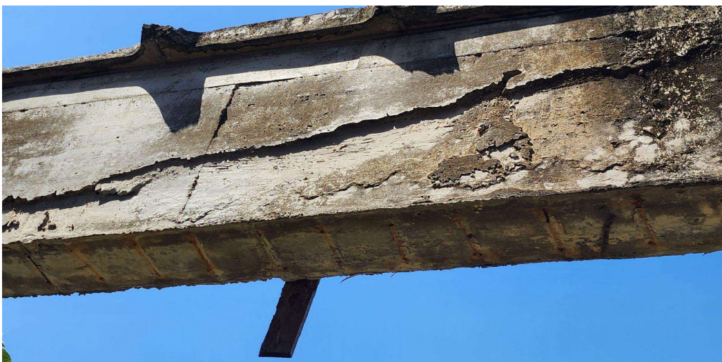
Figura 68: Vazios de concretagem provocados pela movimentação de formas da viga V31
