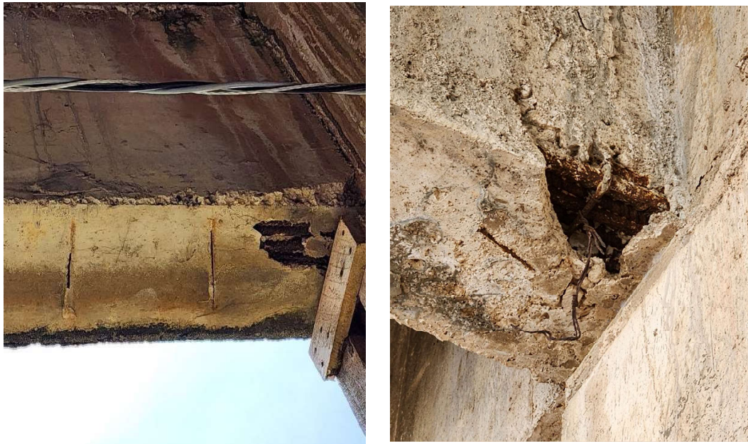
Figura 65: Segregação provocada pela concentração de armaduras longitudinais nas vigas V48 e V29
