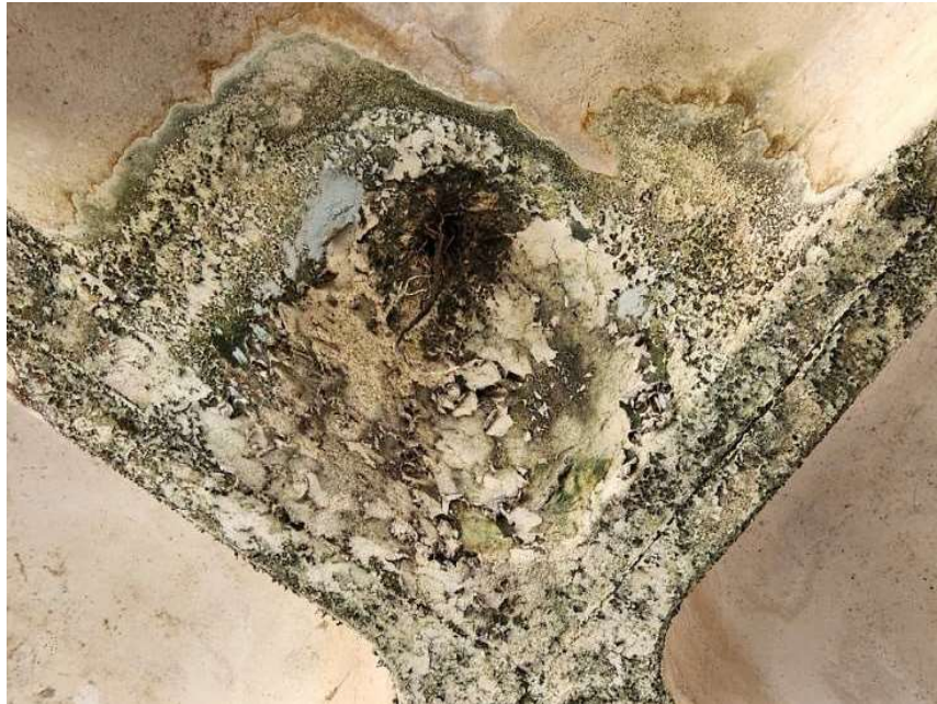
Figura 47: Desagregação e rompimento de parte da laje L13 devido a proliferação de bolor e vegetação.
