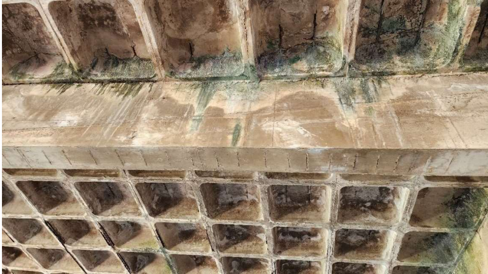
Figura 55: Viga V8 com a superfície úmida e com manchas de eflorescência
