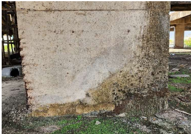
Figura 74: Manchas de umidade e proliferação de vegetação na base do pilar P15
