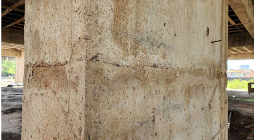
Figura 44: Segregação e desagregação em junta de concretagem no pilar P16
