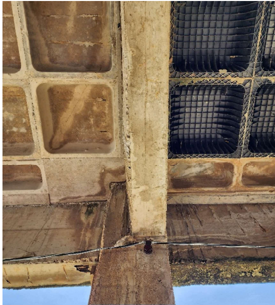
Figura 61: Viga V43 em desaprumo
