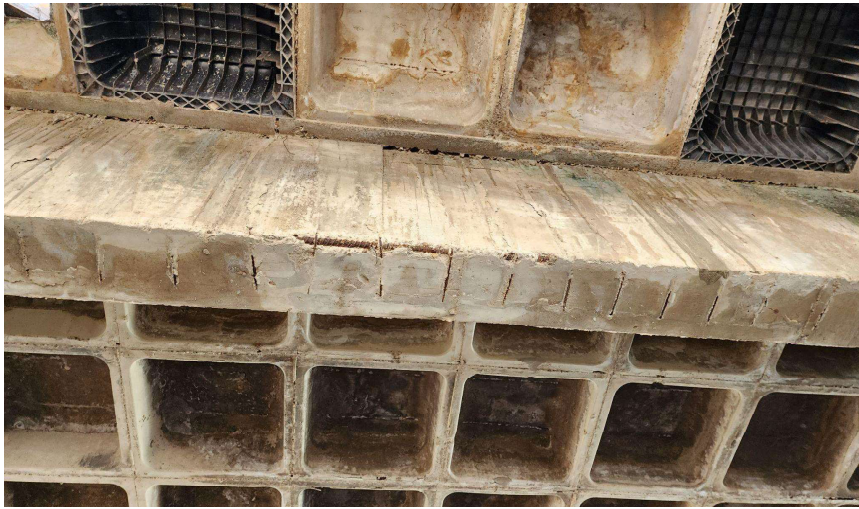
Figura 40: Umidade presente na viga V24 acompanhada de corrosão das armaduras longitudinais e transversais
