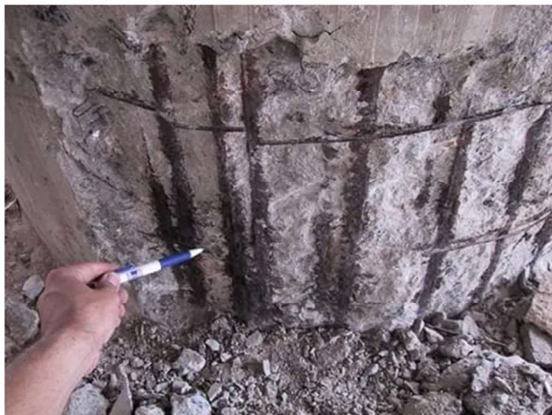
Figura 10: Corrosão de armadura e deslocamento da base de um pilar
