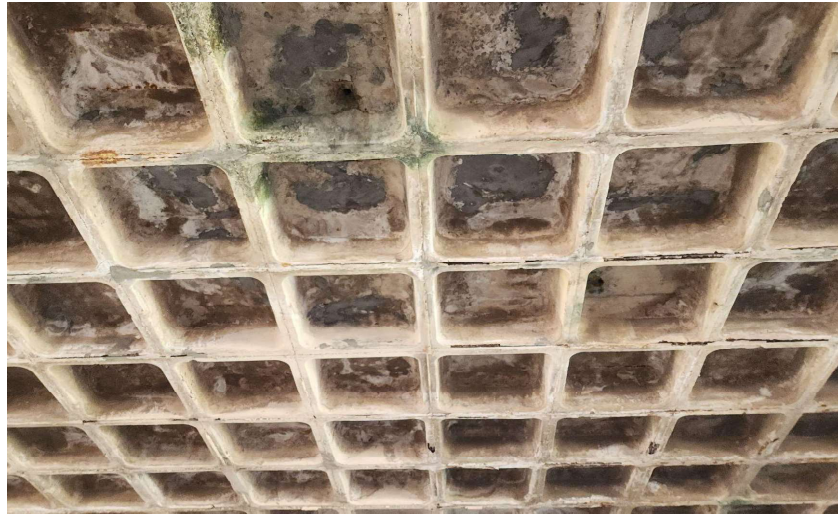
Figura 49: Desagregação do concreto na L5 provocada pela percolação de umidade
