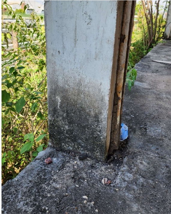
Figura 73: Manchas de umidade ascendente na base do pilar P11
