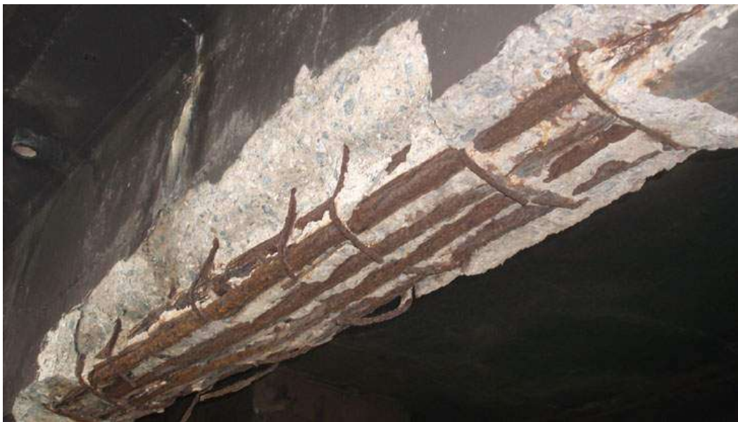
Figura 12: Deslocamento da viga devido a corrosão das armaduras longitudinais
