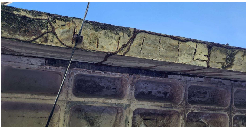
Figura 48: Ataque de cupim na viga V20
