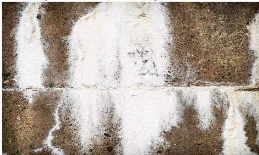
Figura 16: Eflorescência em parede de concreto
