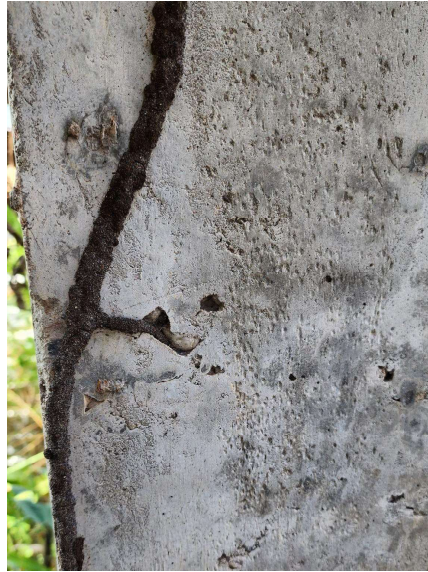
Figura 32: Pilar P18 com porosidade elevada e infestação de cupins
