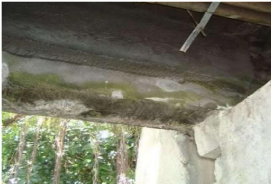
Figura 18: Viga com manchas características da presença de bolores
