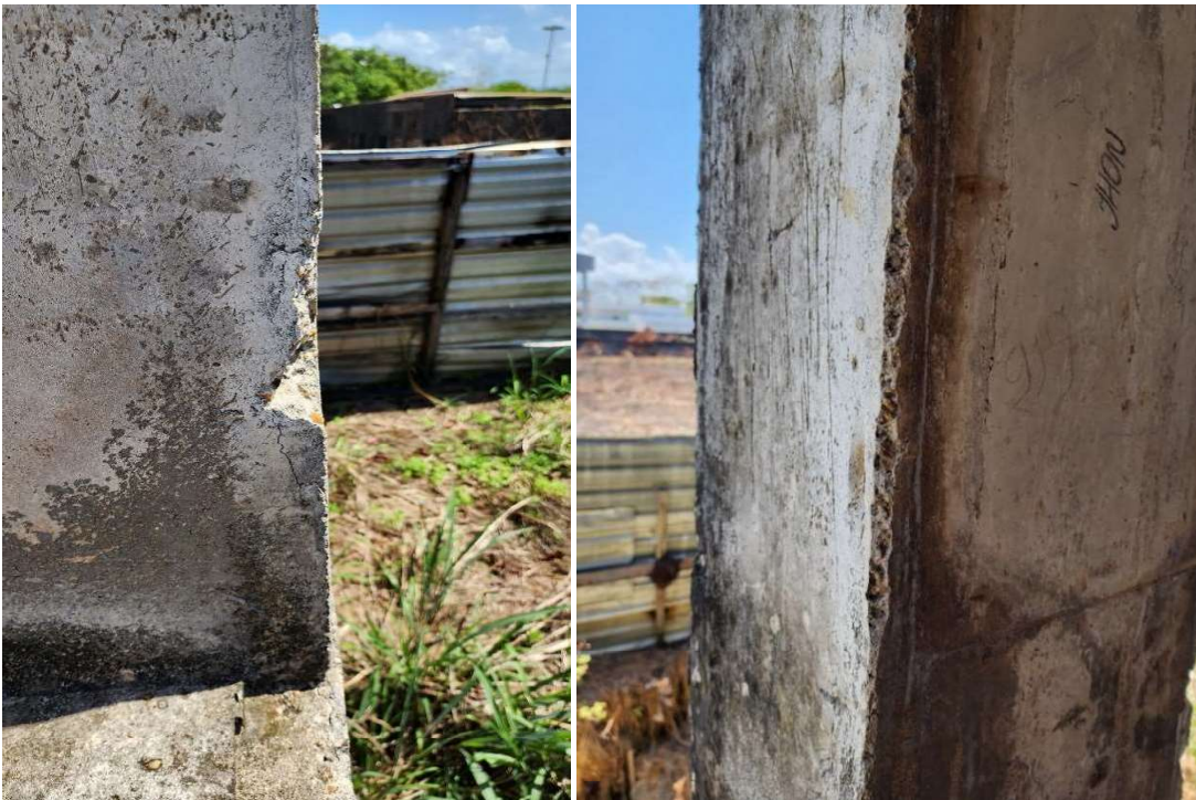
Figura 53: Pilares P1 e P19 apresentam lascamento das suas extremidades
