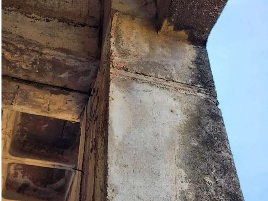
Figura 57: Fissuras no topo do pilar P35
