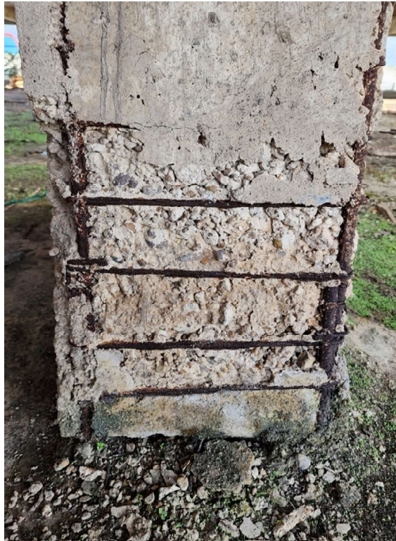
Figura 46: Desagregação da base do pilar P15 enfraquecido pela segregação
