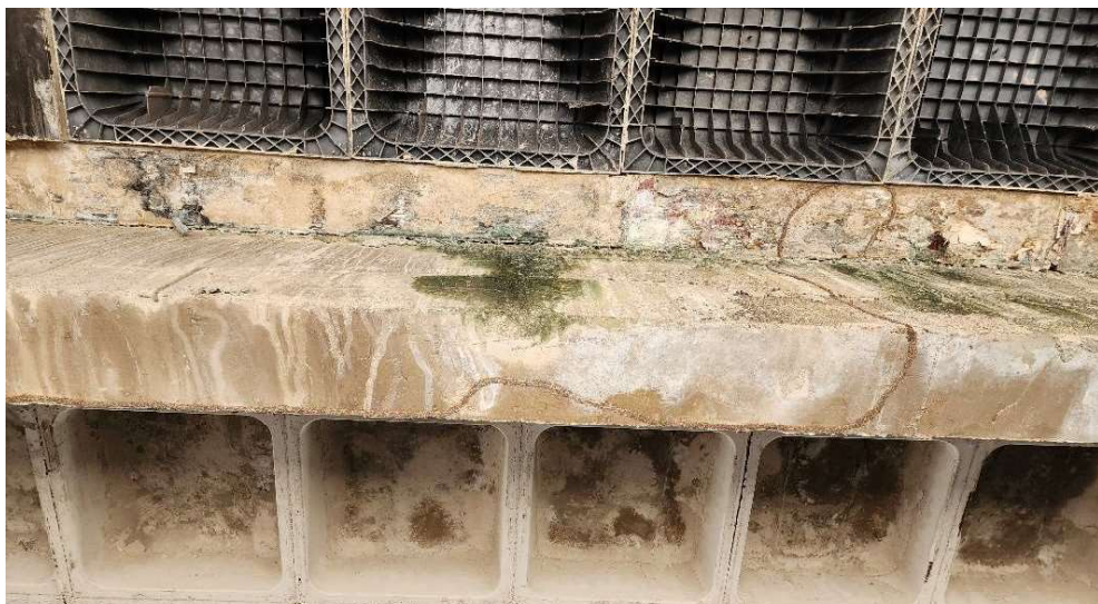
Figura 56: Viga V35 com manchas de eflorescência
