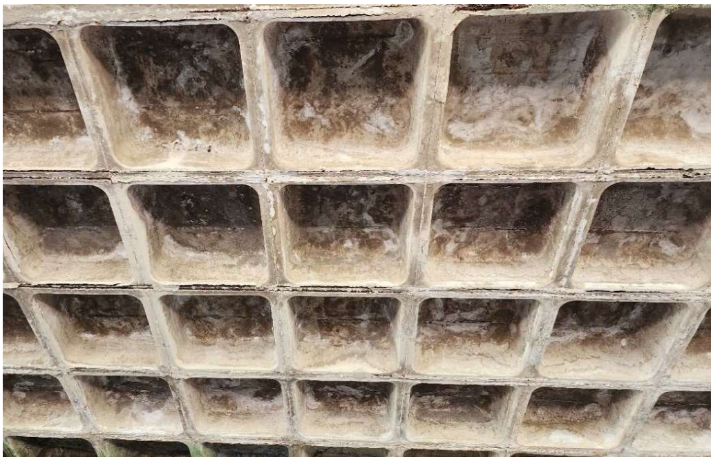
Figura 54: Laje L2 com manchas de eflorescência
