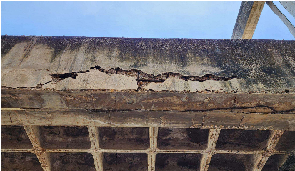
Figura 69: Vazios de concretagem provocados pela movimentação de formas da viga V45
