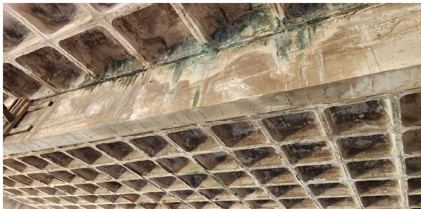
Figura 39: Umidade aparente na viga V8
