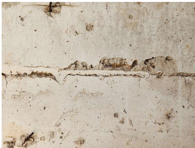
Figura 43: Pilar P21 com desagregação em juntas de concretagem resultante de movimentação de formas
