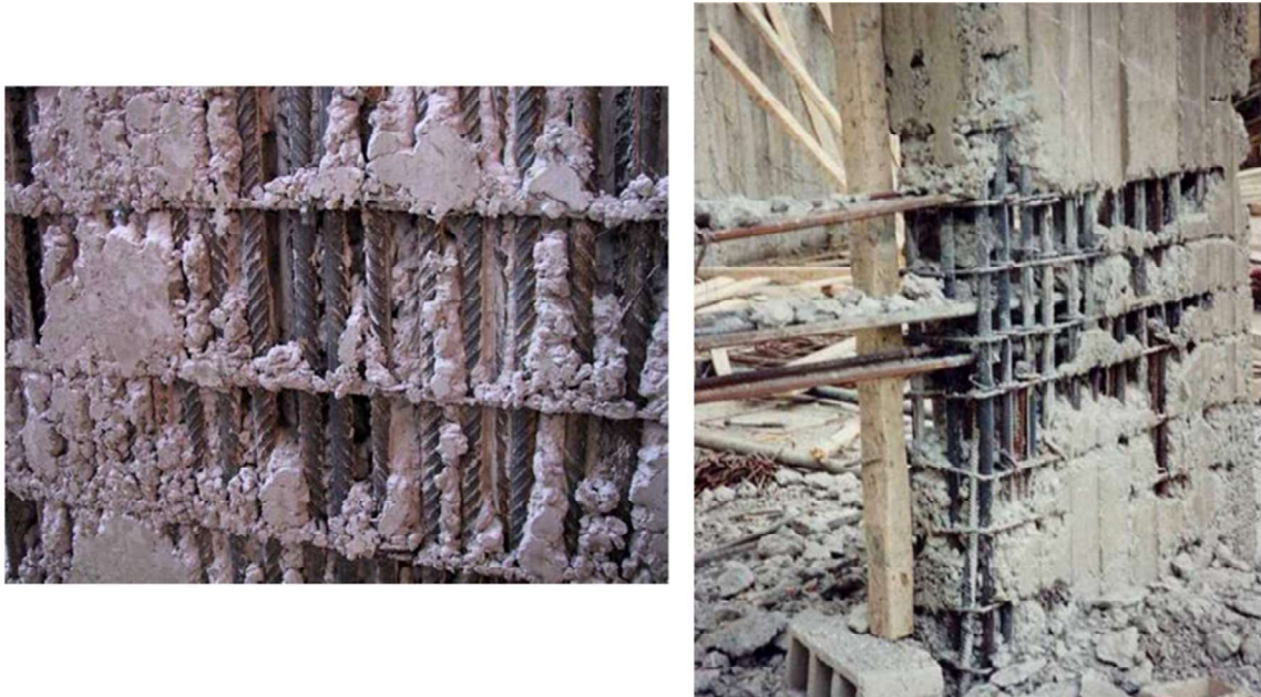
Figura 13: Segregação em pé de pilar
