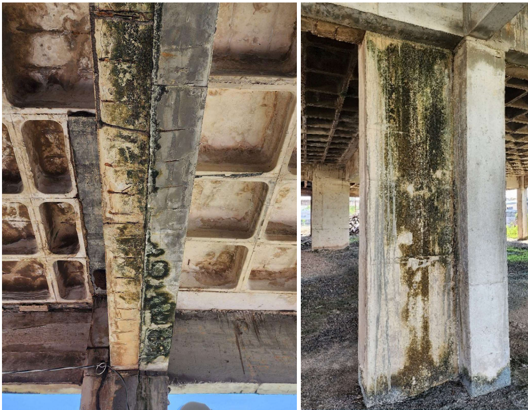
Figura 72: Infiltração de água pelas juntas de dilatação da viga V9 e pilar P10
