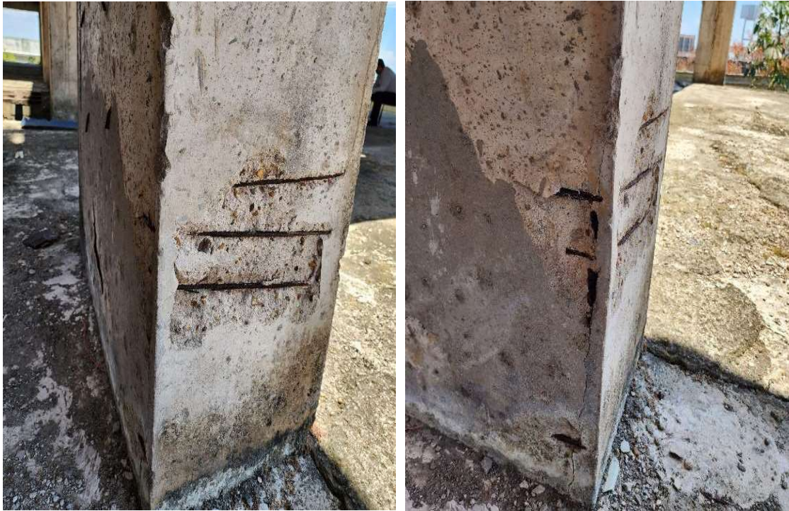
Figura 51: Pilar P14 apresentando disgregação nas duas faces
