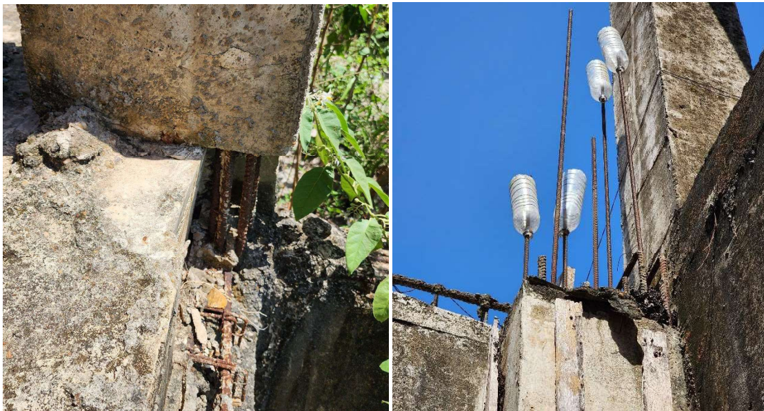
Figura 41: P3 e P24 apresentando armaduras de espera em processo de corrosão
