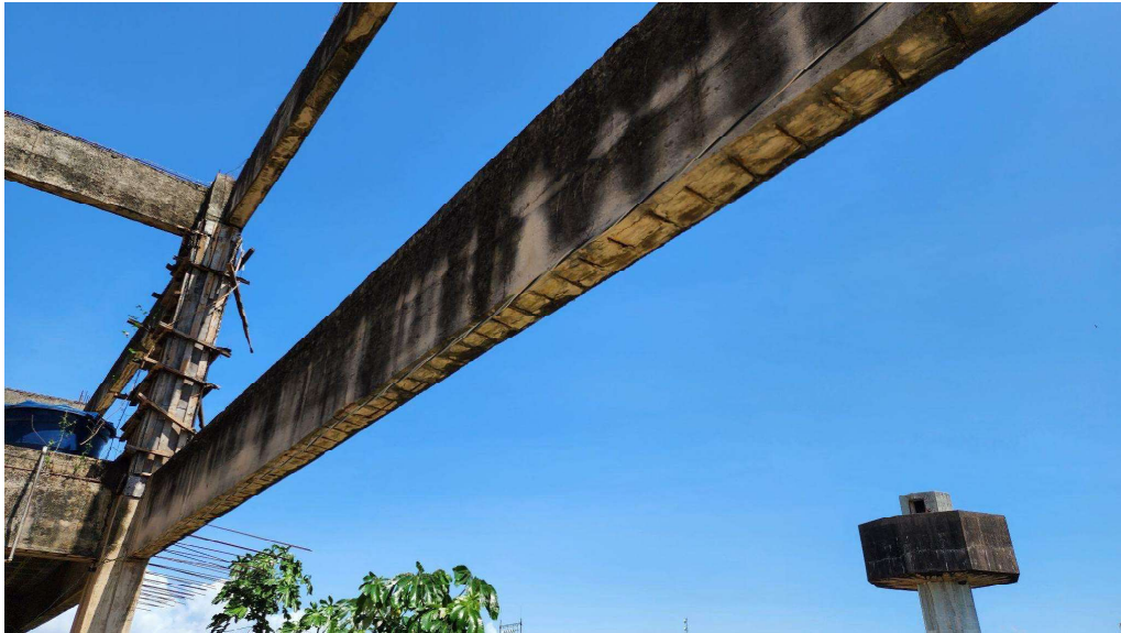
Figura 31: Viga V14 exposta às intempéries
