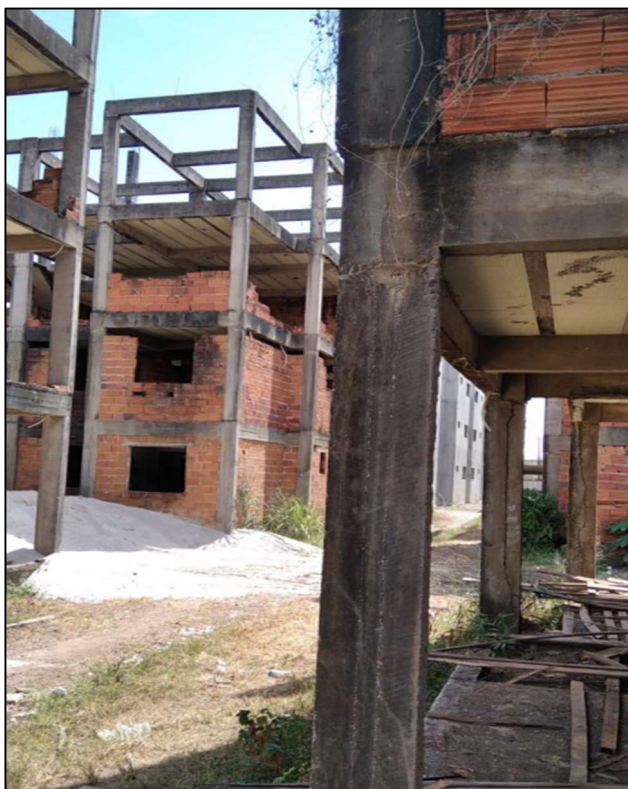
Figura 16 - Falta de Retilneidade
