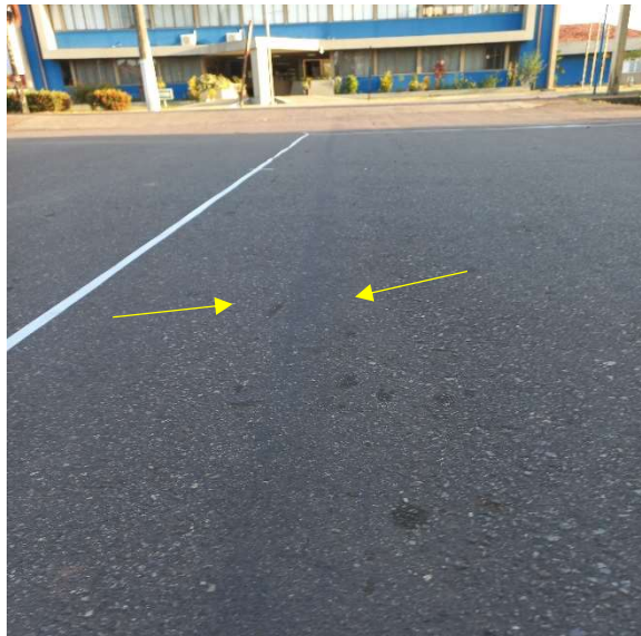
Figura 106 – Afundamento de Trilho de Roda - Área de avaliação 23.
