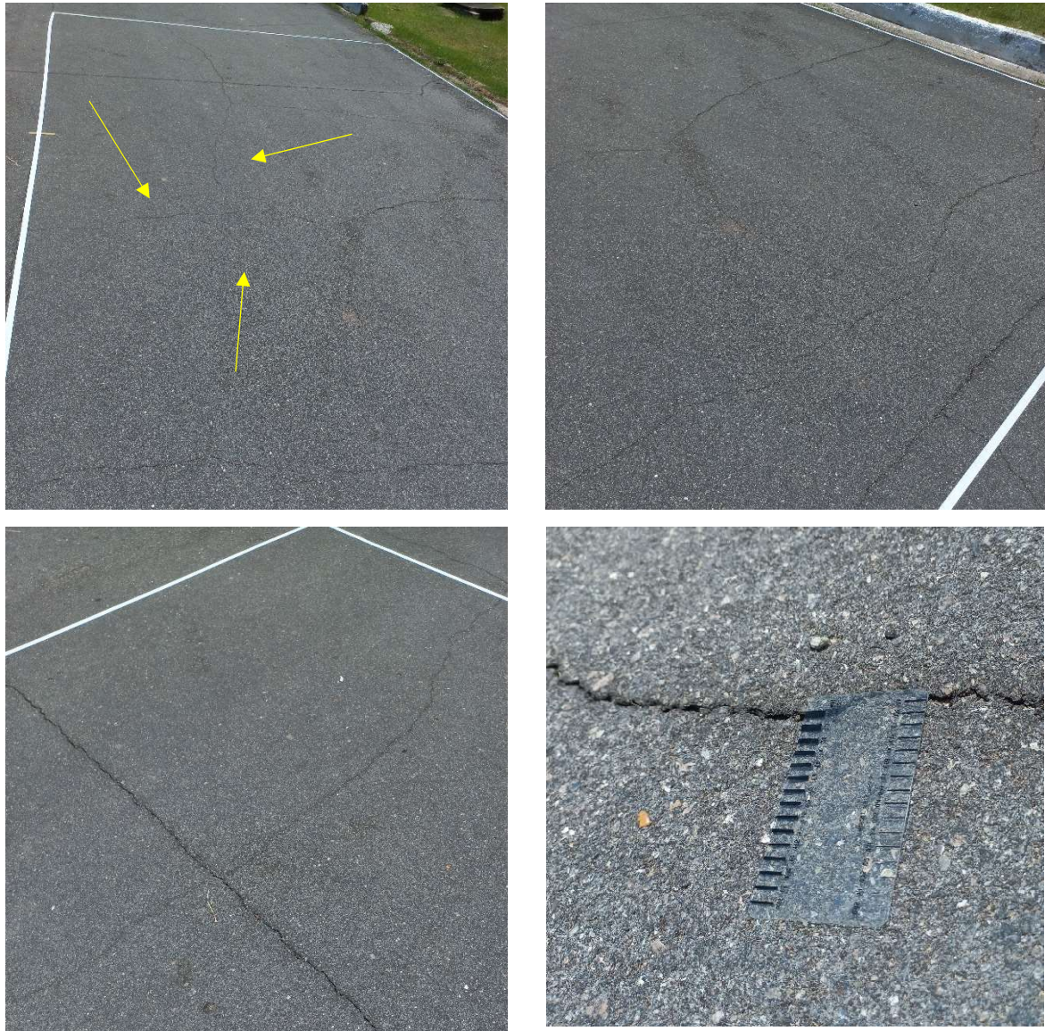
Figura 35 – Trinca Interligada Tipo “Bloco” - Área de avaliação 4.
