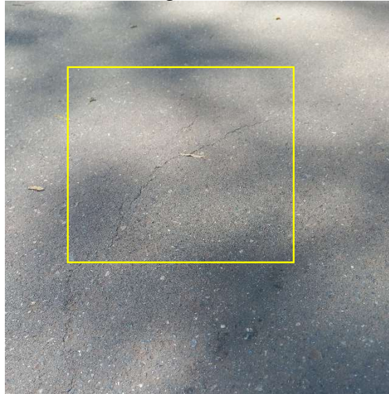
Figura 86 – Trinca Isolada Longitudinal Curta - Área de avaliação 18.
