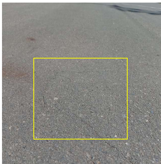
Figura 83 – Trinca Isolada Longitudinal Curta - Área de avaliação 17.
