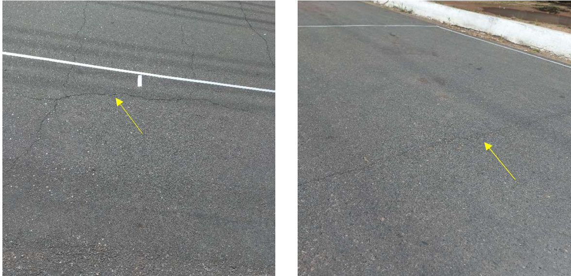
Figura 68 – Trinca Isolada Longitudinal e Transversal Longa - Área de avaliação 13.
