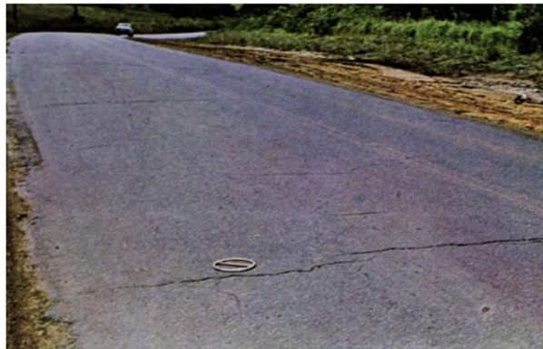
Figura 5 - Trinca isolada – transversal.
