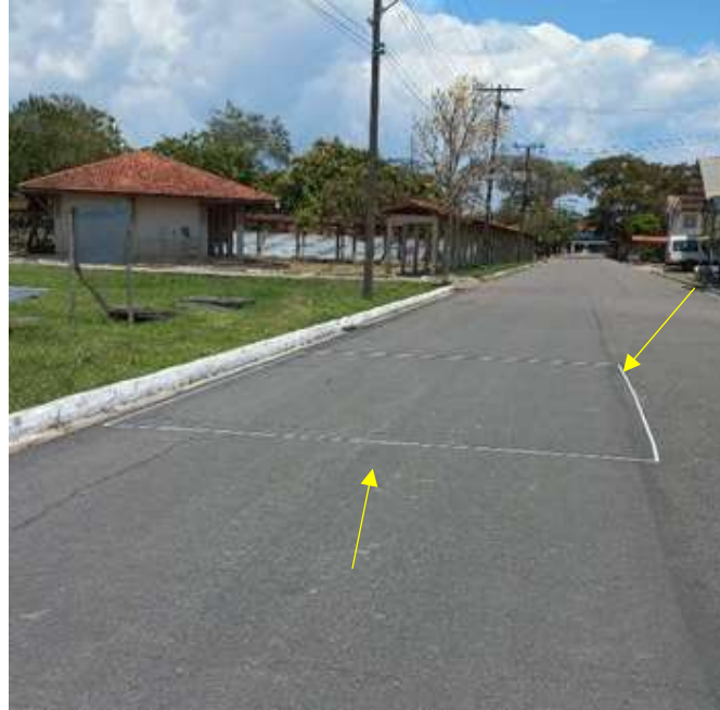
Figura 57 – Afundamento de Trilho de Roda - Área de avaliação 10.
