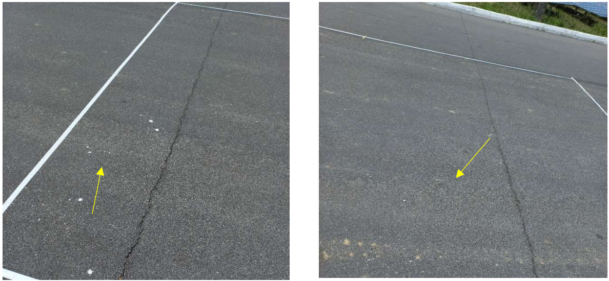
Figura 53 – Desgaste, Afundamento de Trilho de Roda e Trinca Transversal Longa - Área de avaliação 9.
