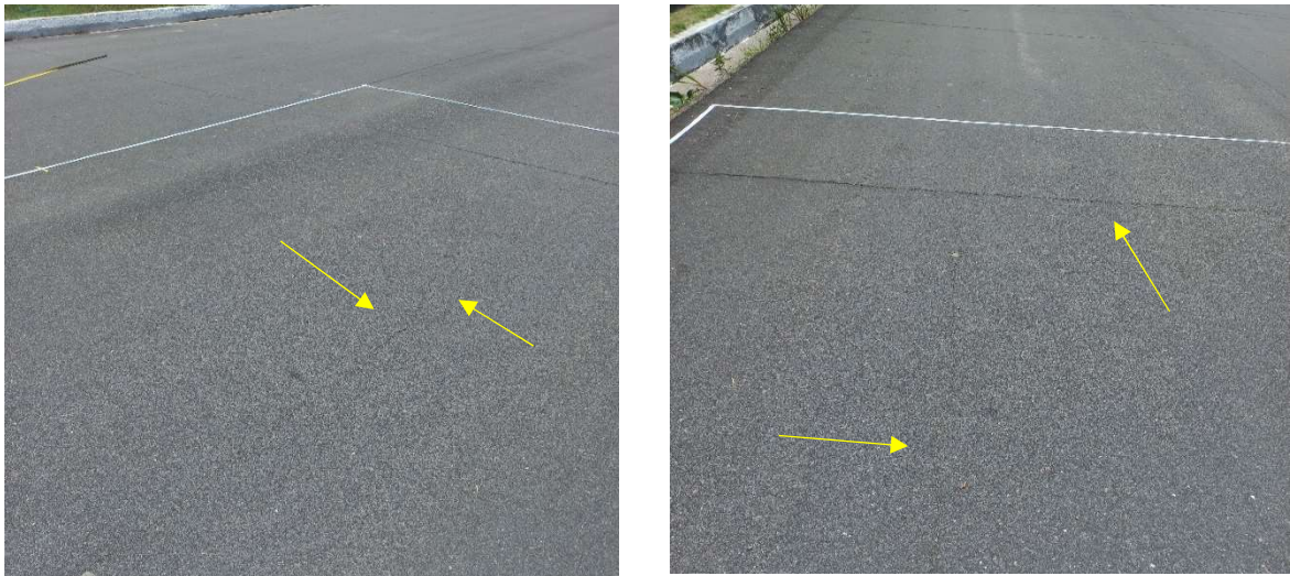
Figura 46 – Trinca Isolada Longitudinal e Transversal Longa - Área de avaliação 7.
