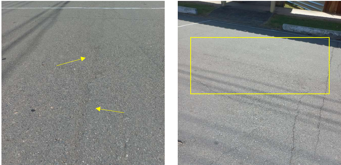
Figura 74 – Afundamento de Trilho de Roda - Área de avaliação 14.
