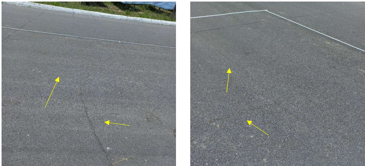
Figura 52 – Trinca Isolada Longitudinal e Transversal Longa - Área de avaliação 9.
