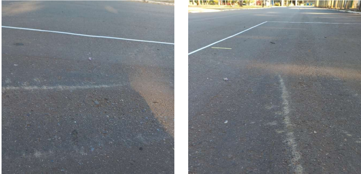
Figura 90 – Afundamento de Trilho de Roda - Área de avaliação 19.
