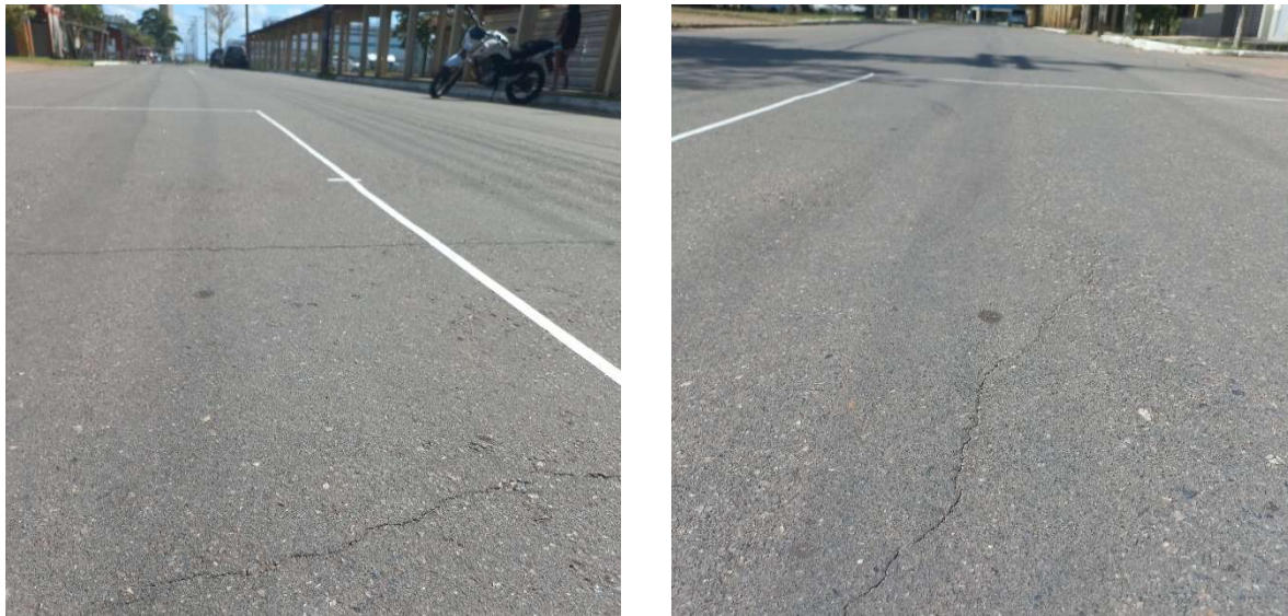
Figura 76 – Trinca Isolada Longitudinal e Transversal Longa - Área de avaliação 15.
