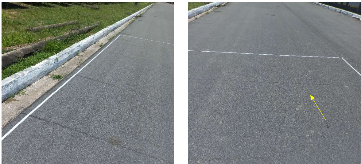
Figura 50 – Trinca Isolada Transversal Longa e Desgaste - Área de avaliação 8.
