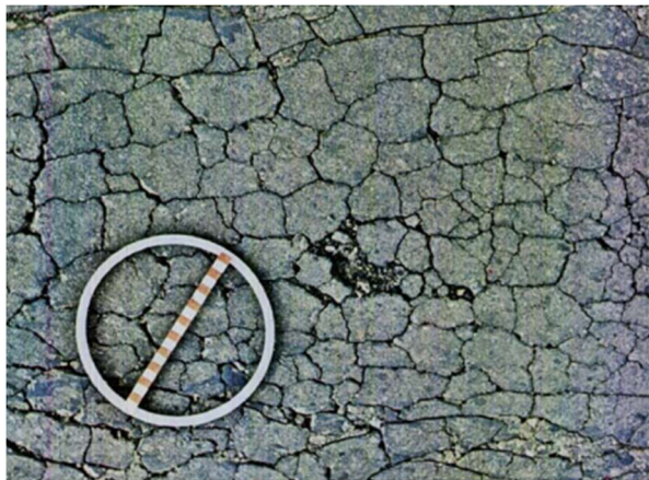
Figura 7 – Trinca interligada – tipo jacaré.
