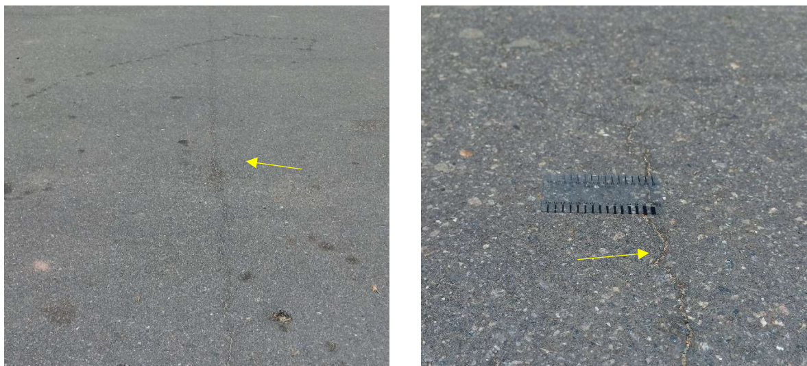
Figura 60 – Trinca Isolada Transversal Longa - Área de avaliação 11.
