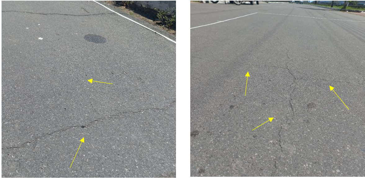
Figura 64 – Trinca Isolada Longitudinal e Transversal Longa - Área de avaliação 12.
