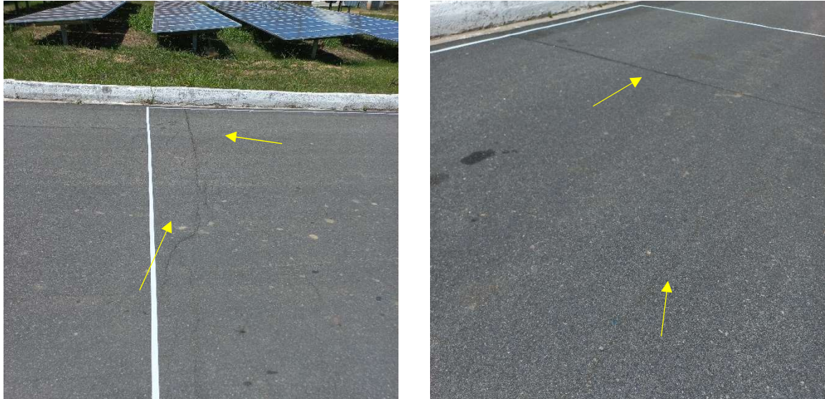
Figura 55 – Trinca Isolada Longitudinal e Transversal Longa - Área de avaliação 10.
