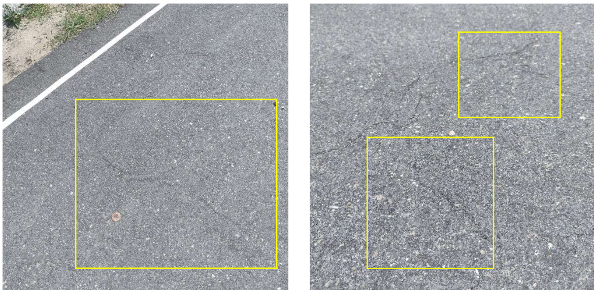
Figura 32 – Trinca Isolada Transversal e Longitudinal Curta - Área de avaliação 3.
