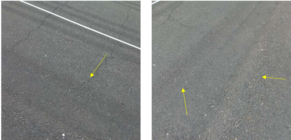
Figura 70 – Afundamento de Trilho de Roda - Área de avaliação 13.
