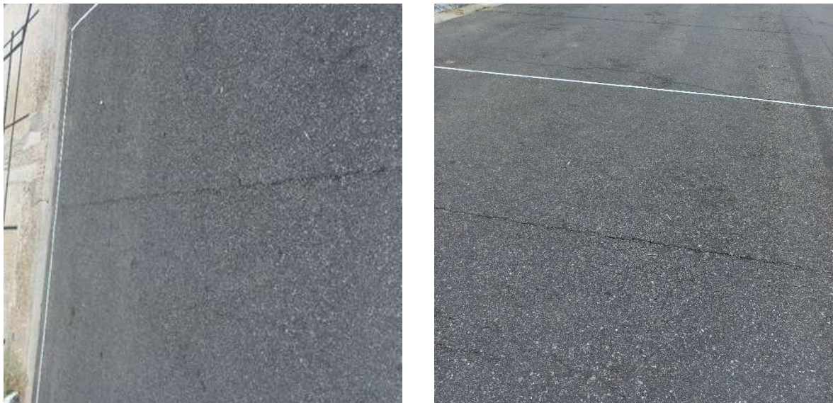
Figura 39 - Trinca Isolada Transversal Longa - Área de avaliação 5.
