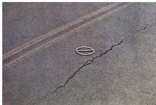
Figura 6 - Trinca isolada – longitudinal.
