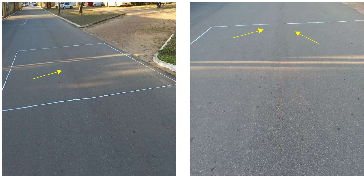
Figura 101 – Afundamento de Trilho de Roda - Área de avaliação 22.
