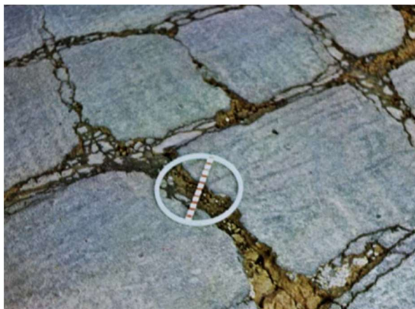
Figura 8 - Trinca interligada – tipo bloco.
