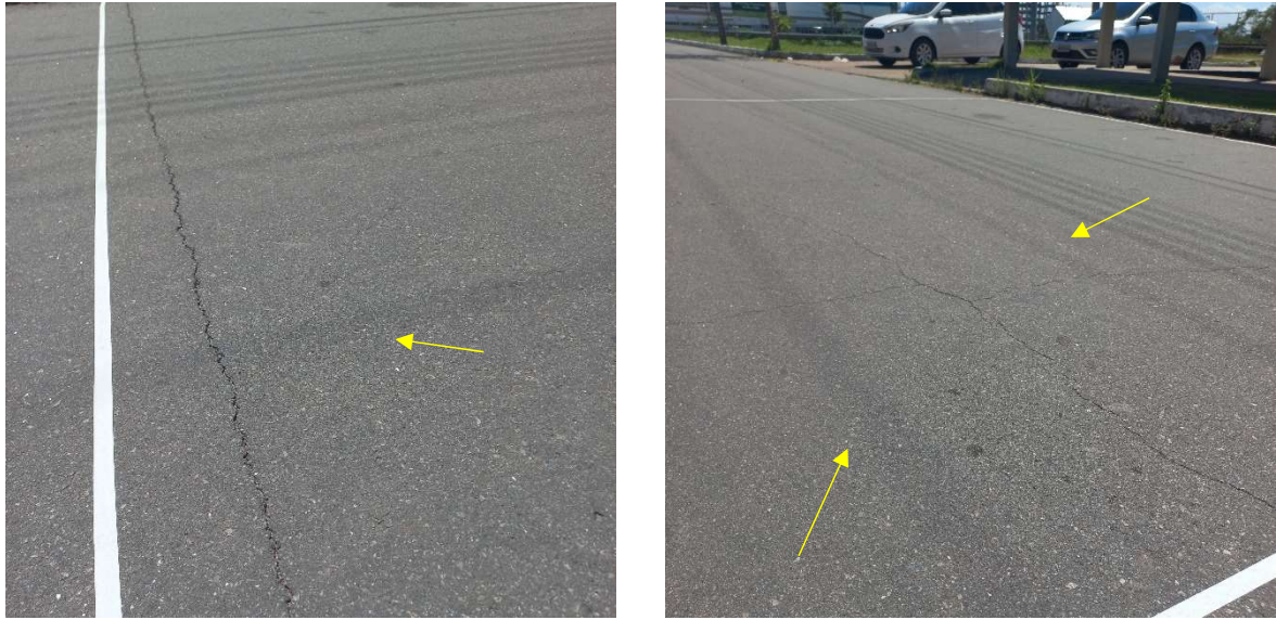
Figura 66 – Afundamento de Trilho de Roda - Área de avaliação 12.
