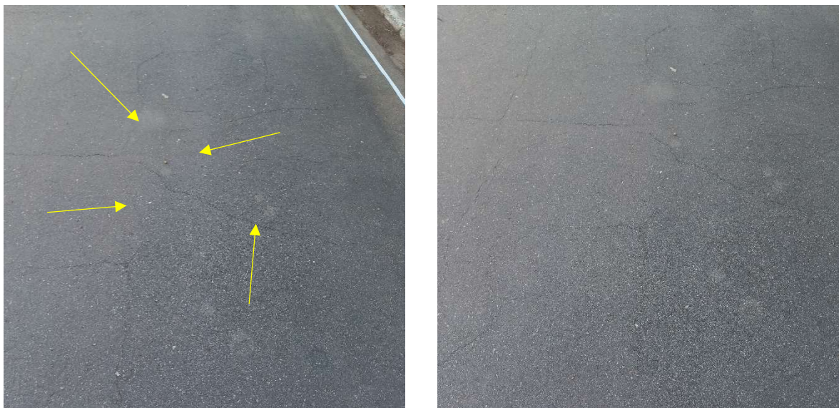
Figura 95 – Trinca Interligada Tipo “Bloco” - Área de avaliação 21.
