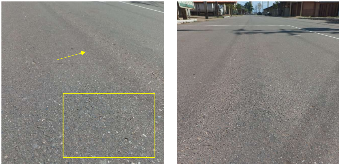
Figura 84 – Desgaste e Afundamento de Trilho de Roda - Área de avaliação 17.
