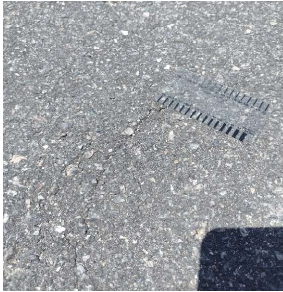
Figura 27 – Trinca Isolada Longitudinal Curta – Área de avaliação 1.
