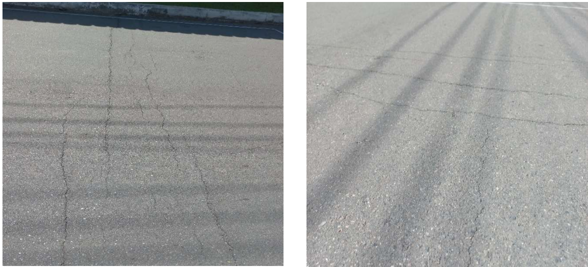
Figura 72 – Trinca Isolada Longitudinal e Transversal Longa - Área de avaliação 14.
