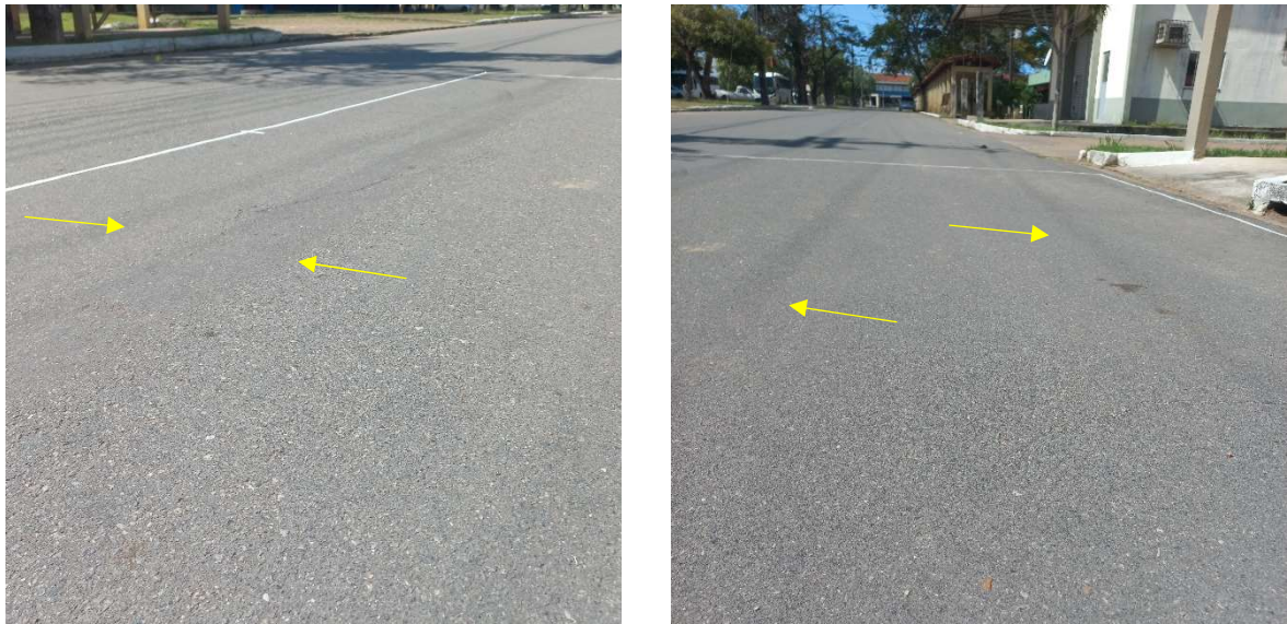
Figura 78 – Afundamento de Trilho de Roda - Área de avaliação 15.
