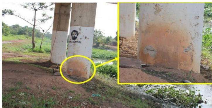
Figura 21 - Destacamento do revestimento da estrutura
