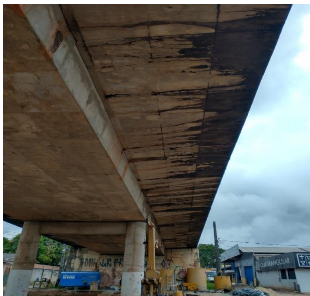
Figura 20 - Manchas e eflorescências na região inferior do tabuleiro
