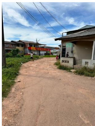
Fotografia 2 – área sem pavimento
