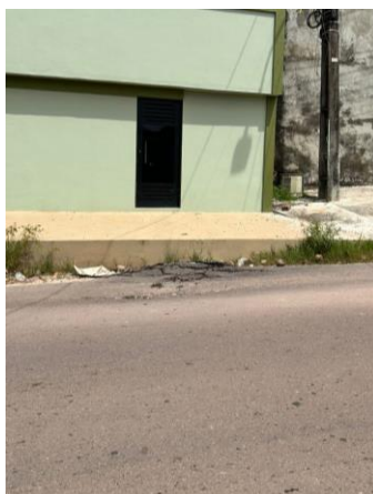
Fotografia 5 – deformação no pavimento
