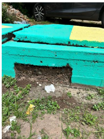
Fotografia 10 – boca de lobo com grelha entupida
