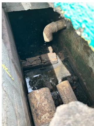
Fotografia 18 – ligação clandestina na boca de lobo
