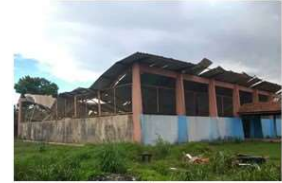
Figura 16 - (a) Ventania destrói telhado de quadra de escola em Macapá (b) Telhado de corredor de escola do AP desaba e fere sete crianças e adolescentes
