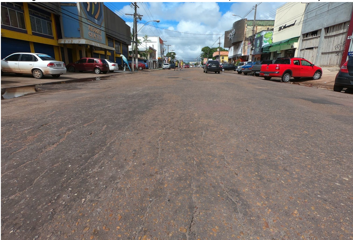
Figura 24 - Av. Padre Julio Maria De Lombaerd - detalhes para ausência de sinalização
