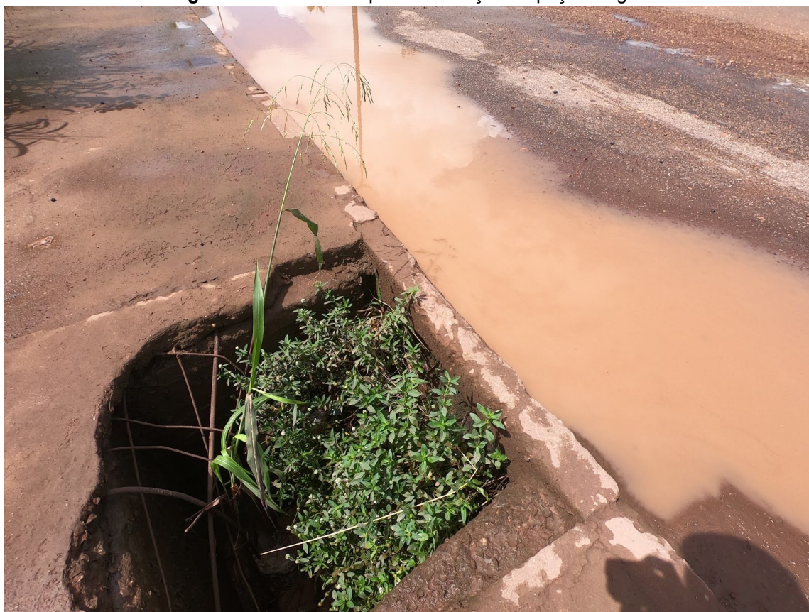
Figura 28 - Bueiro entupido e formação de poças d'água
