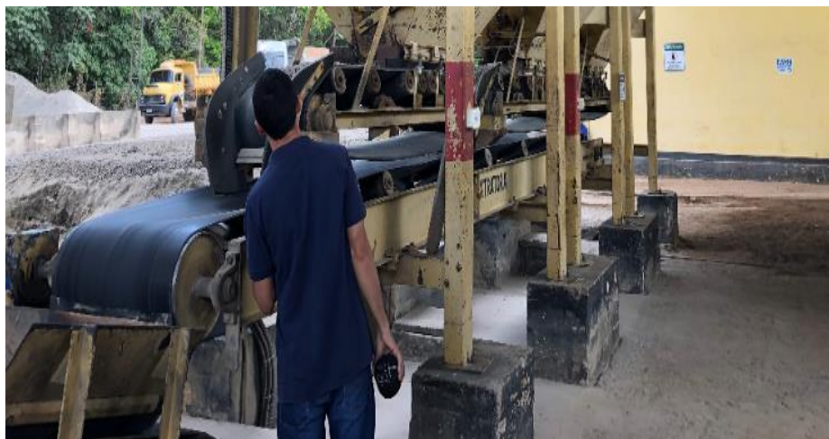
Figura 14 - Correia transportadora Fonte: Os autores (2018)
