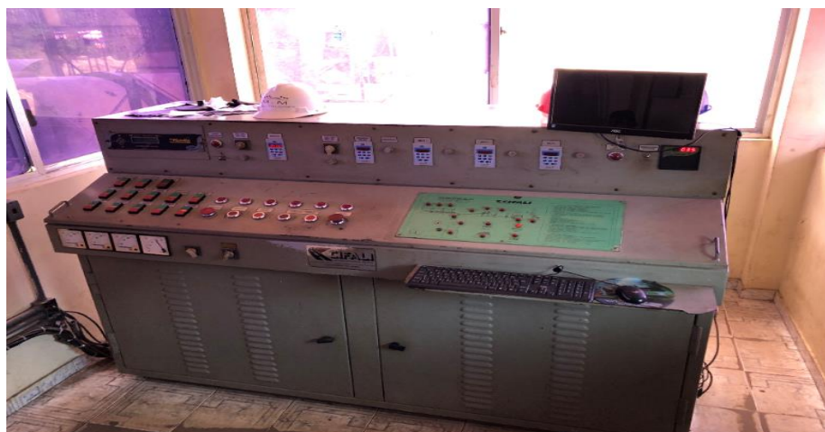
Figura 19 - Torre de comando da usina Fonte: Os autores (2018)
