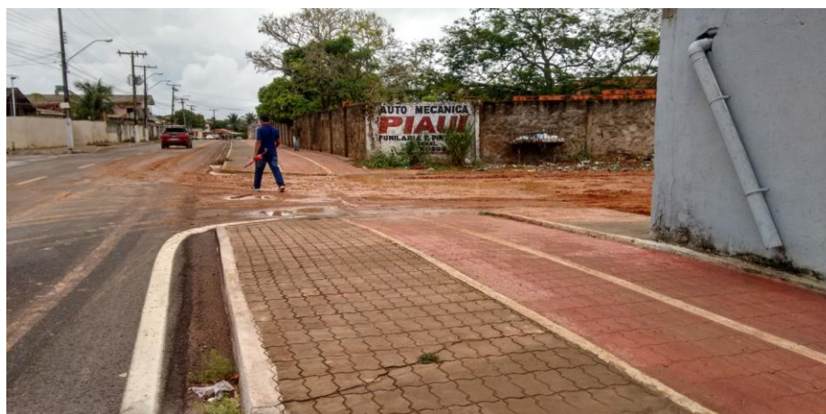
Figura 5 - Tv. 2 - não pavimentada - com Av. Caubi Sérgio Melo - pavimentada; bairro Renscer II Fonte: Os autores (2018)
