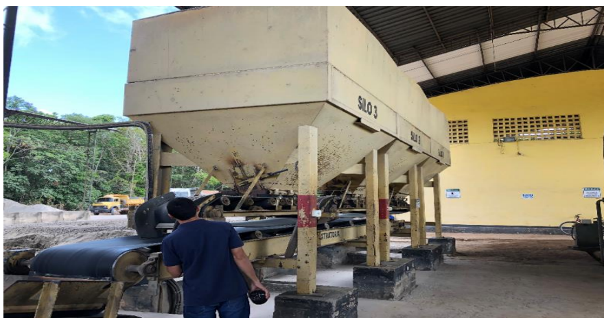
Figura 13 - Silos de agregados frios Fonte: Os autores (2018)
