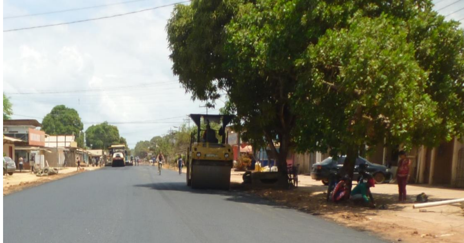
Figura 24 - Compressor tandem Fonte: Os autores (2018)
