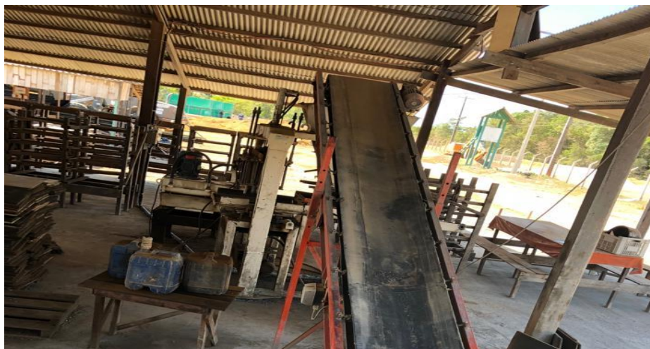
Figura 31 – Esteira de concreto
