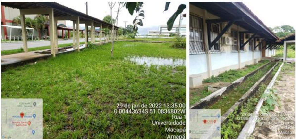
Imagem 7: Infiltração em áreas verdes (esquerda) e trincheiras de infiltração típicas nos blocos do campus (direita).
