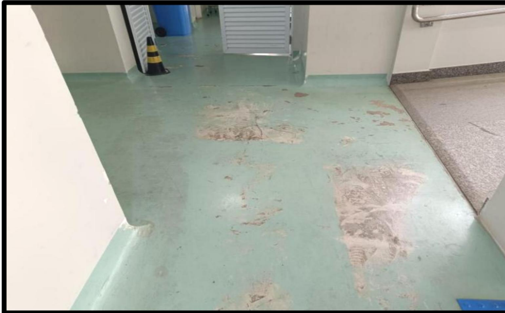
FIGURA 20- DESGASTE POR ABRASÃO DO REVESTIMENTO EPÓXI
