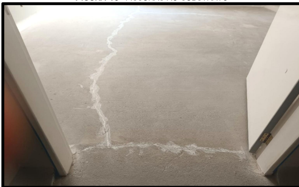
FIGURA 19- FISSURAS AO SUBSTRATO
