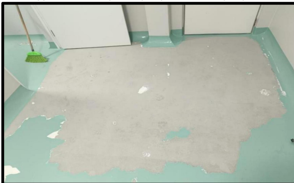
FIGURA 17- DESPLACAMENTOS DO REVESTIMENTO EPÓXI
