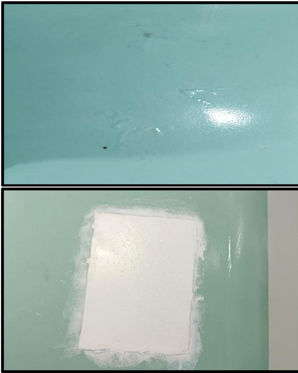
FIGURA 18- MANIFESTAÇÃO PATOLÓGICA BOLHAS/EMPOLAMENTOS EM CORREDOR DO AMBULATÓRIO
