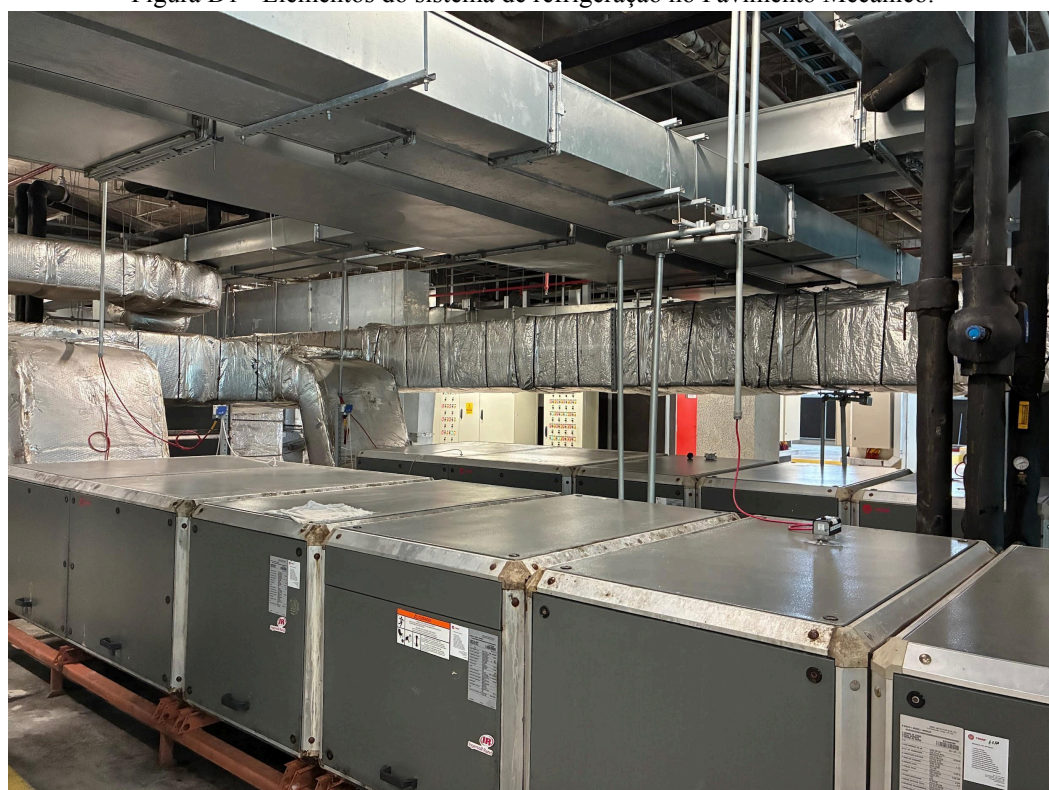
Figura D1 - Elementos do sistema de refrigeração no Pavimento Mecânico.
