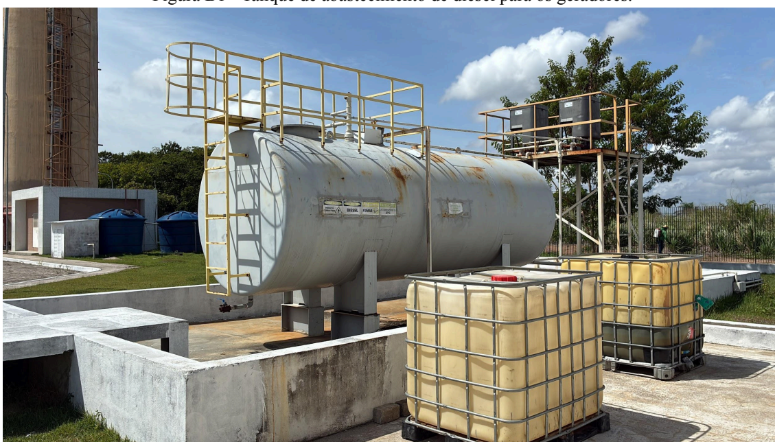
Figura B1 - Tanque de abastecimento de diesel para os geradores.
