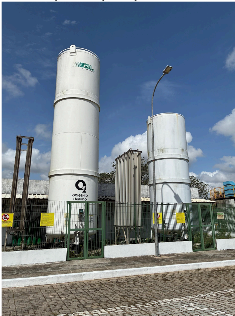
Figura C1 - Tanques com gases medicinais.
