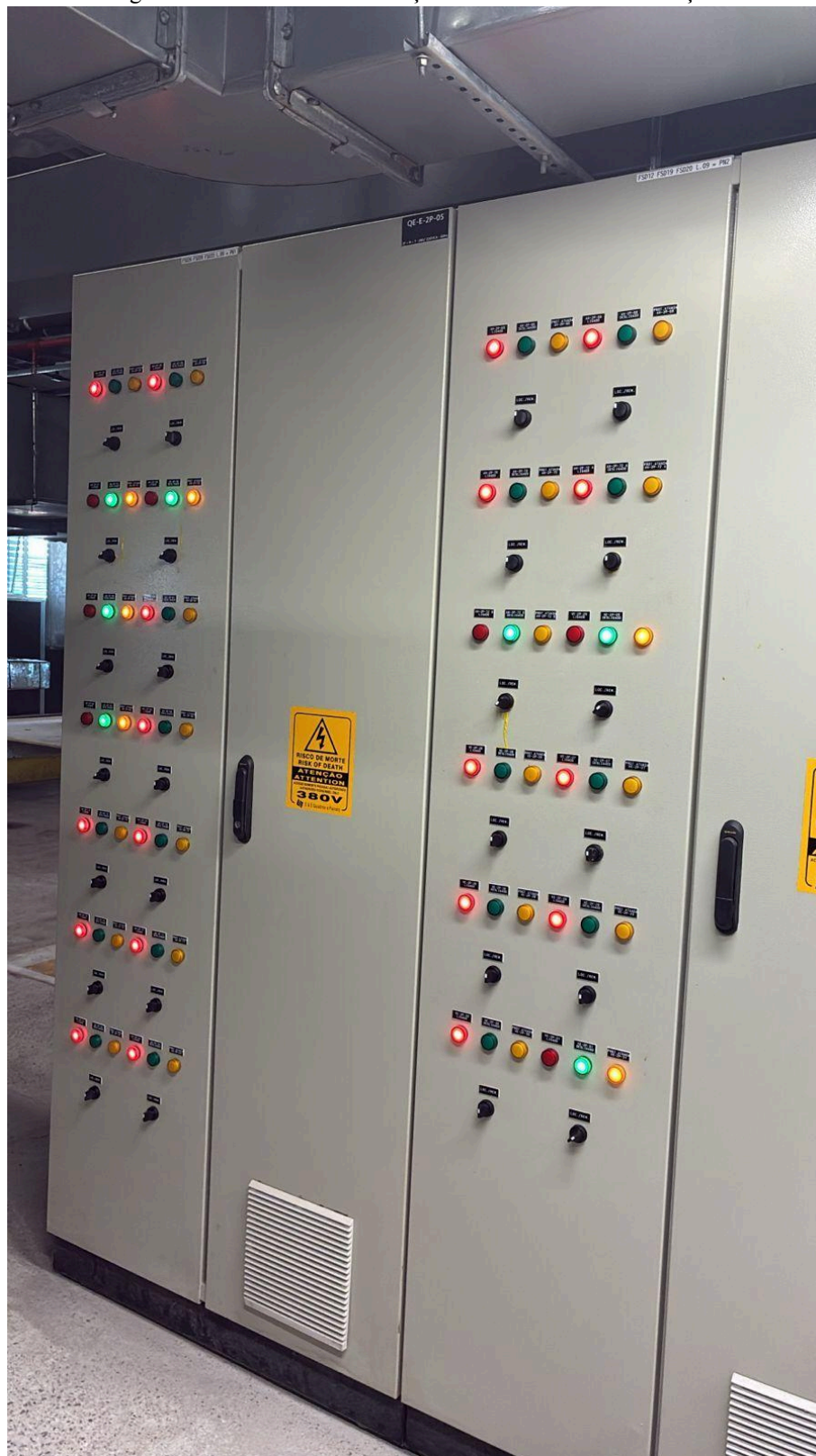
Figura F1 - Painéis de Automação do Sistema de Climatização.
