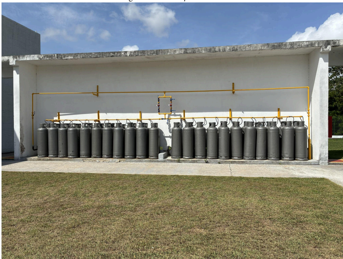
Figura C4 - Instalações de GLP.
