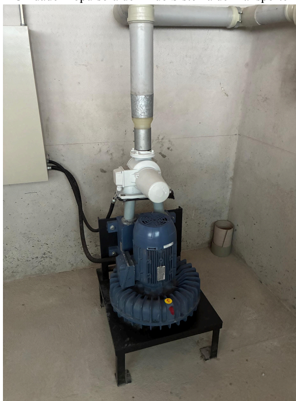
Figura E2 - Unidade Propulsora de Ar do Sistema de Transporte Pneumático.
