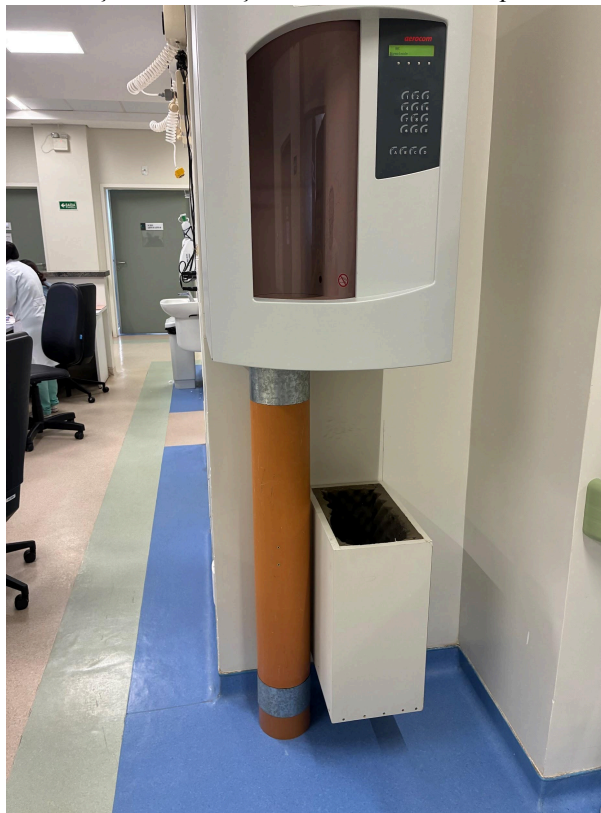
Figura E1 - Estação de utilização do Sistema de Transporte Pneumático.
