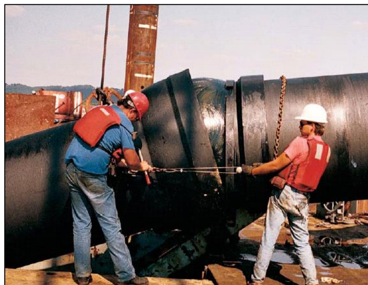
Figura 11 - Conexão de tubulação de ferro fundido
