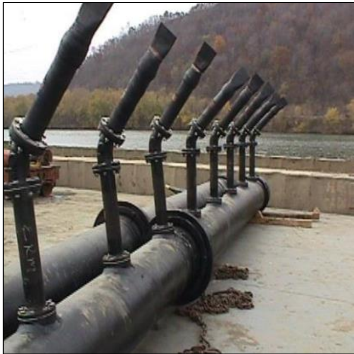
Figura 8 - Emissário submarino de aço com tubulação difusora
