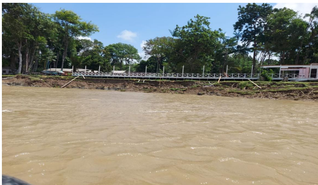
Figura 33: Reiteração do ciclo de instabilidade forçando o desmonte preventivo e o novo recuo da infraestrutura para área mais distante da margem em curto intervalo temporal
