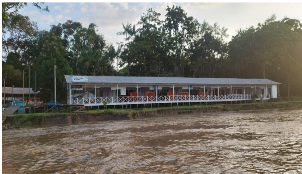
Figura 32: Avanço do processo de erosão marginal resultando no colapso da edificação frontal e ameaça direta à nova estrutura remanescente
