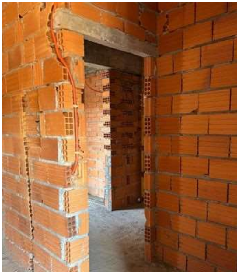
Figura 22 — Ed. Studio Way : instalações elétricas nas adjacências do vão.
