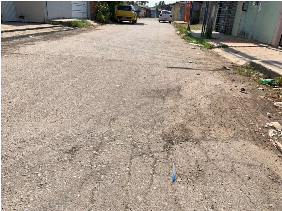
Figura 16: Trincas Longitudinais, Remendos, Agregados Polidos, Corrugações, Desgaste.
