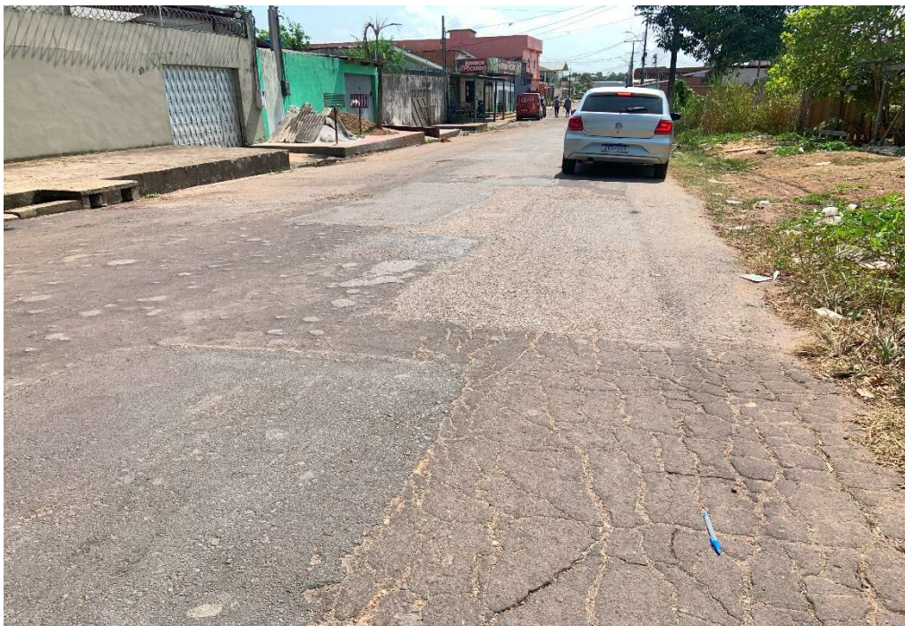
Figura 4: Trincas de blocos, Trincas Longitudinais, Remendos, Exsudação
