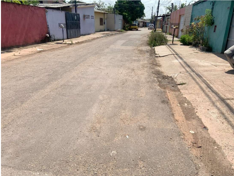
Figura 15: Corrugação, Remendos, Trilha de Roda, Agregados Polidos.
