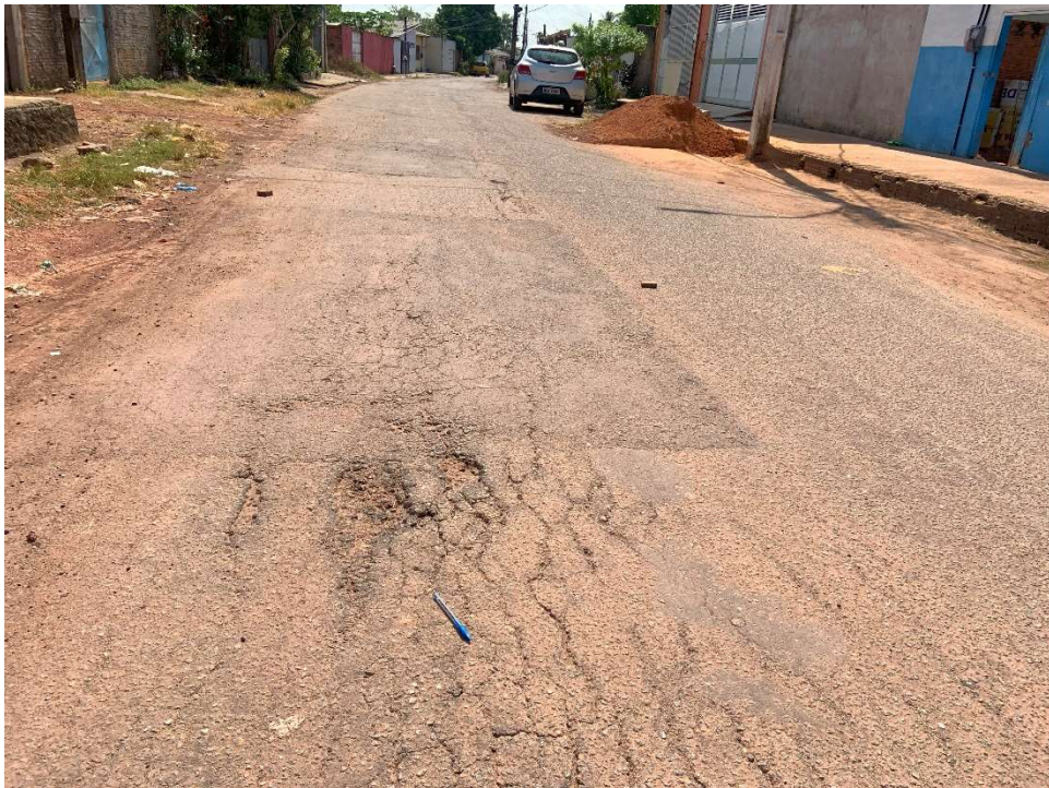
Figura 12: Painéis, Trincas de fadiga, Trincas Longitudinais, Remendos, Agregados Polidos.
