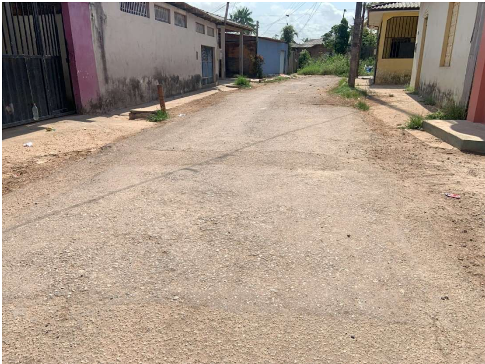
Figura 18: Remendo, Agregado Polido.
