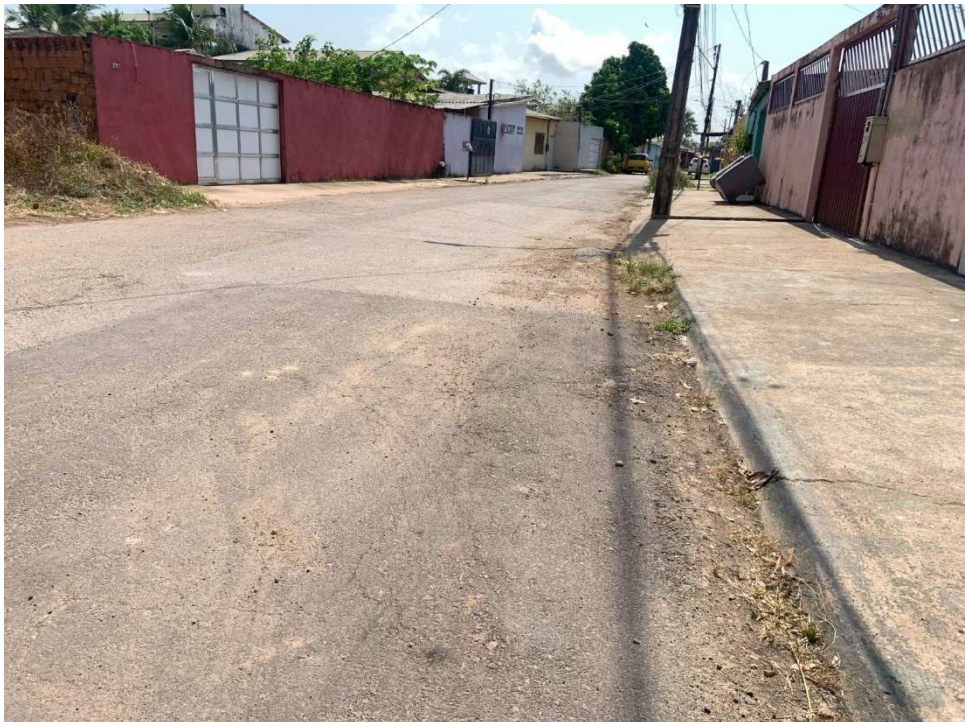
Figura 14: Remendos, Corrugação, Agregados Polidos, Desgaste.
