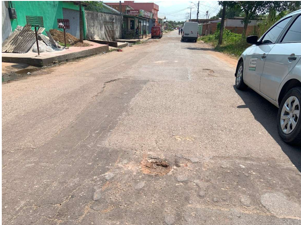
Figura 5: Panela, Trincas Longitudinais, Trilha de Roda, Exsudação, Agregados Polidos.
