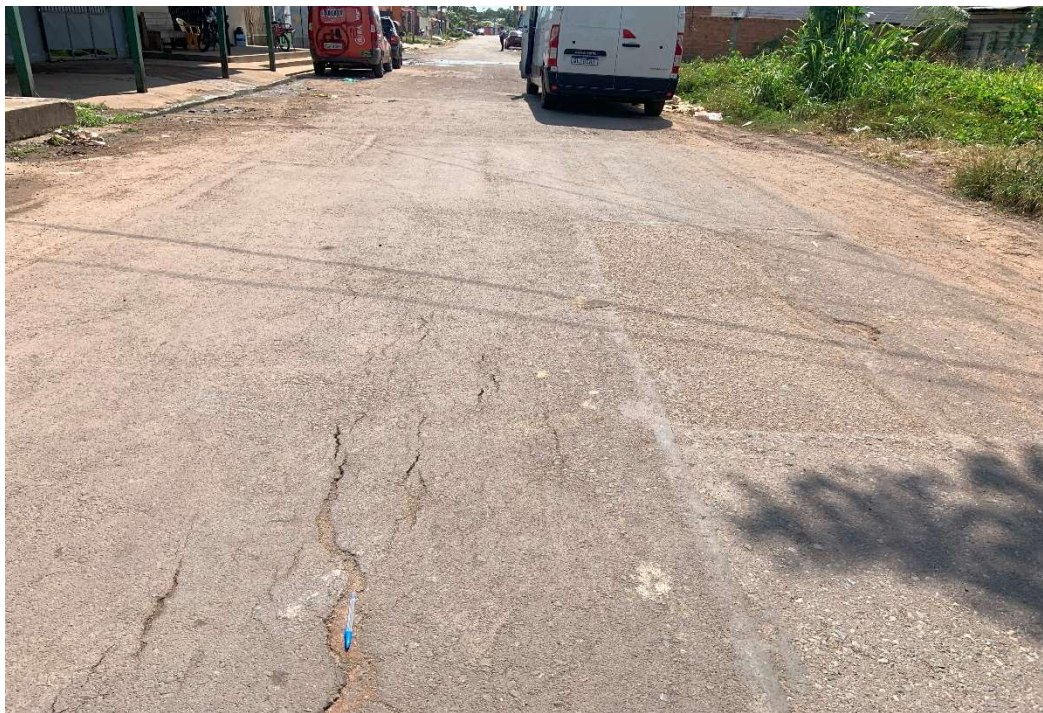
Figura 6: Remendo, Trincas Longitudinais, Desgaste.
