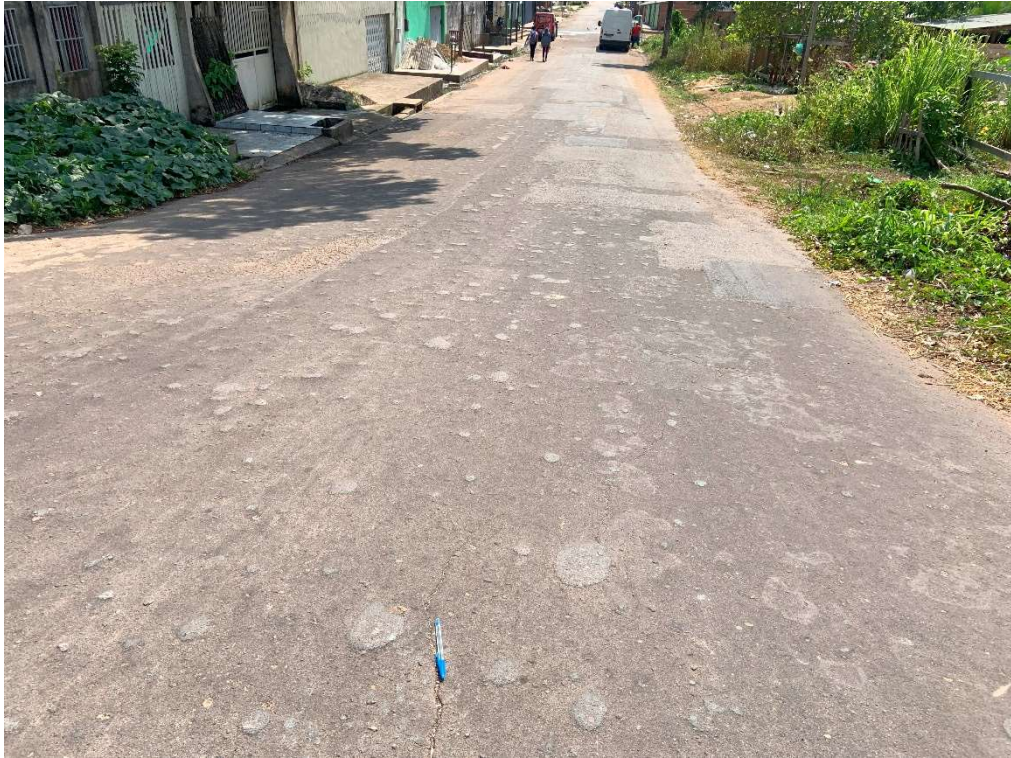
Figura 3: Exsudação, Trincas Longitudinais, Remendos, Agregados Polidos, Exsudação.
