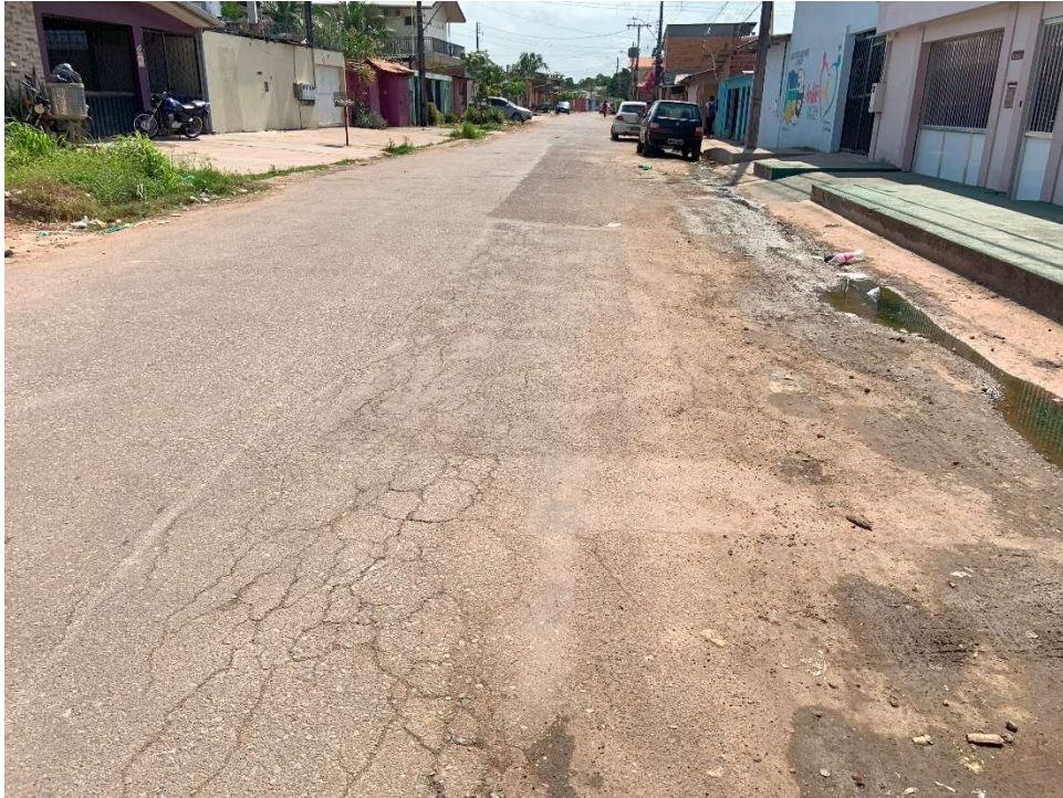
Figura 9: Trincas Longitudinais, Remendos, Corrugações, Trincas de bloco.
