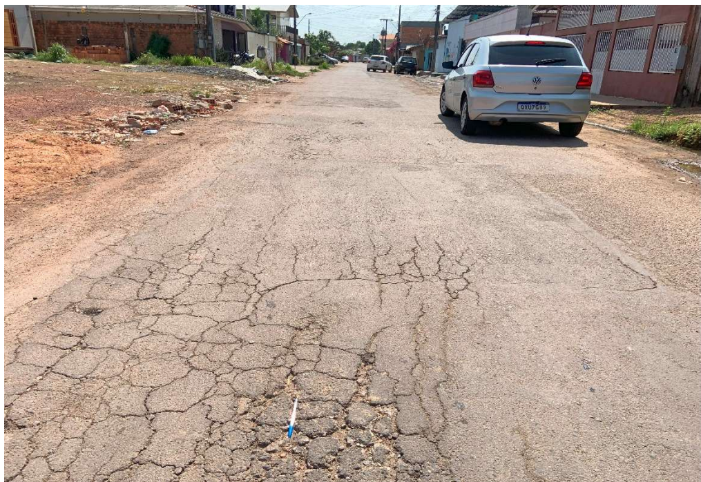
Figura 8: Remendos, Trincas de fadiga, Trincas de bloco, corrugações.
