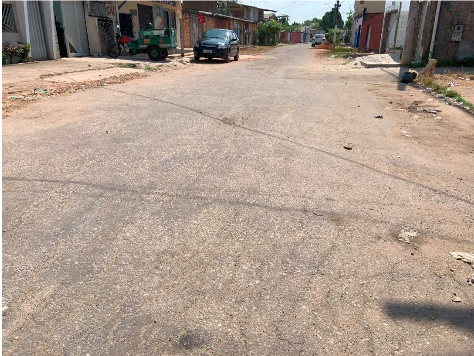
Figura 11: Remendos, Agregados Polidos, Trincas de fadiga.
