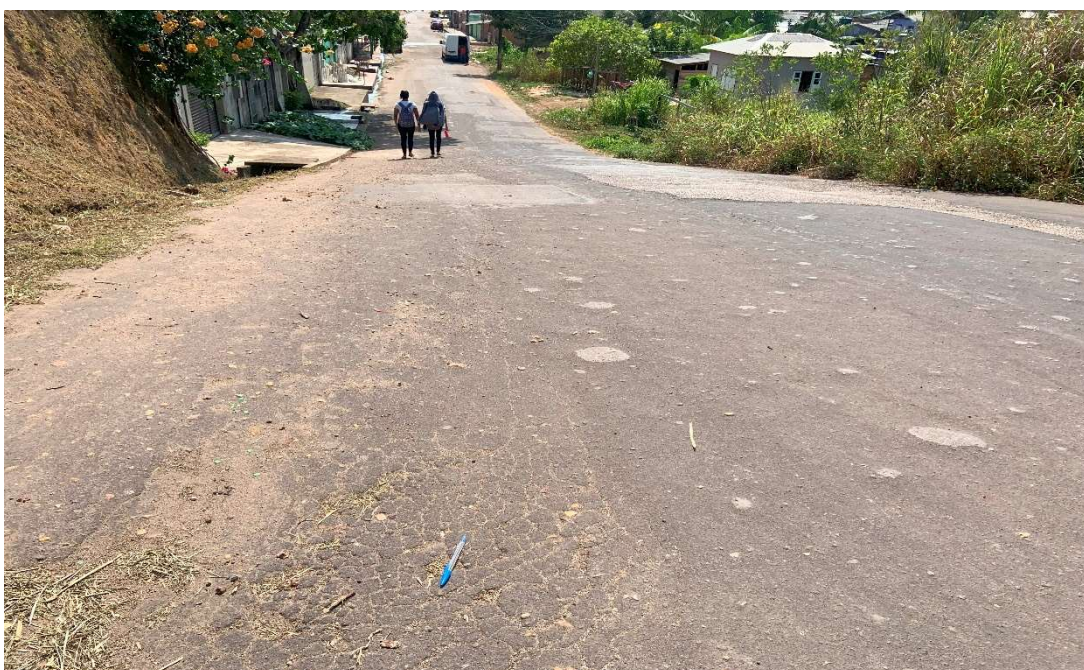
Figura 2: Trincas de fadiga, Trilhas de Roda, Remendos, Agregados Polidos.
