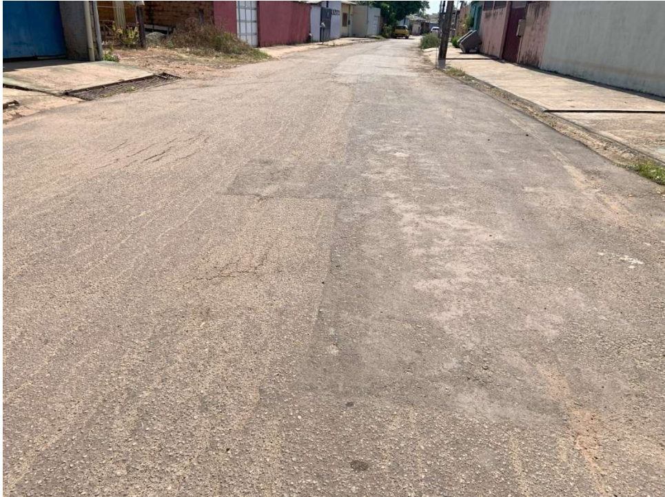
Figura 13: Trincas Longitudinais, Remendos, Corrugação, Agregados Polidos.
