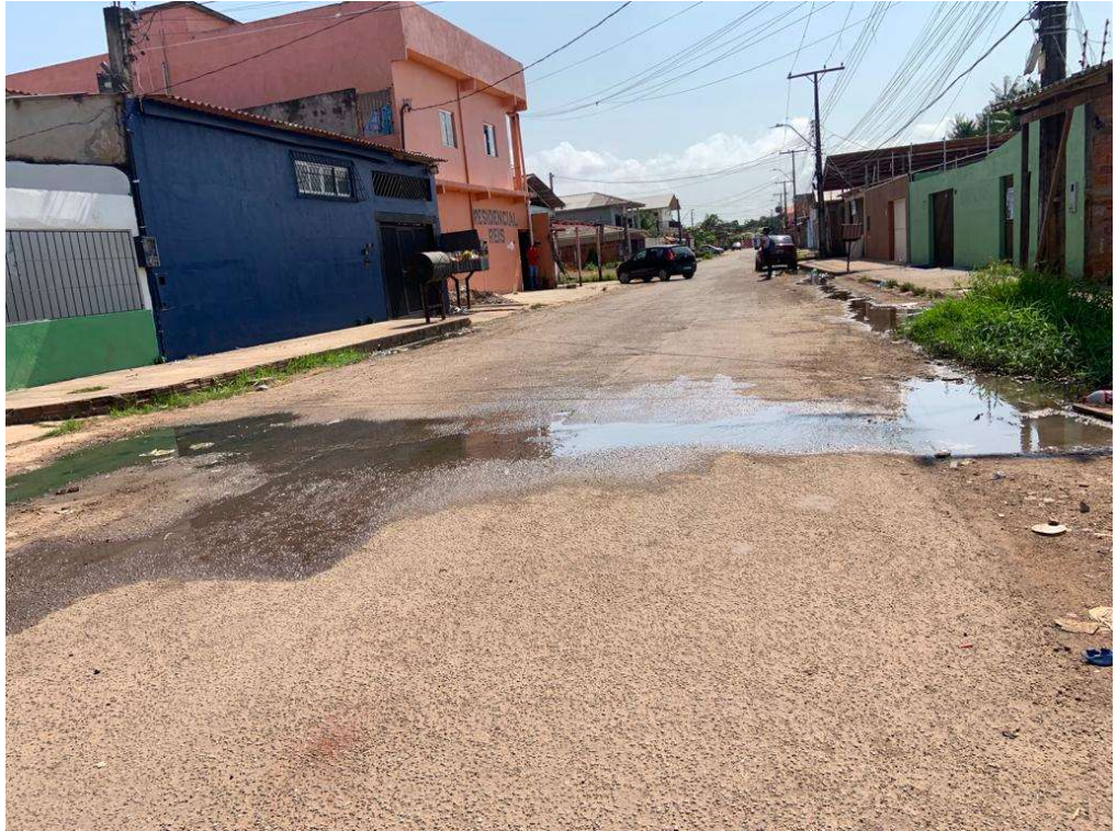
Figura 7: Bombeamento, remendos, agregados polidos.
