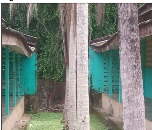
Figura 33 - Telhado e forro deteriorados
