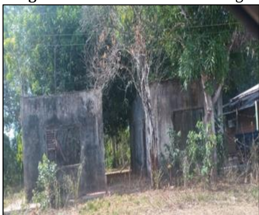
Figura 53 - Ruínas da creche antiga
